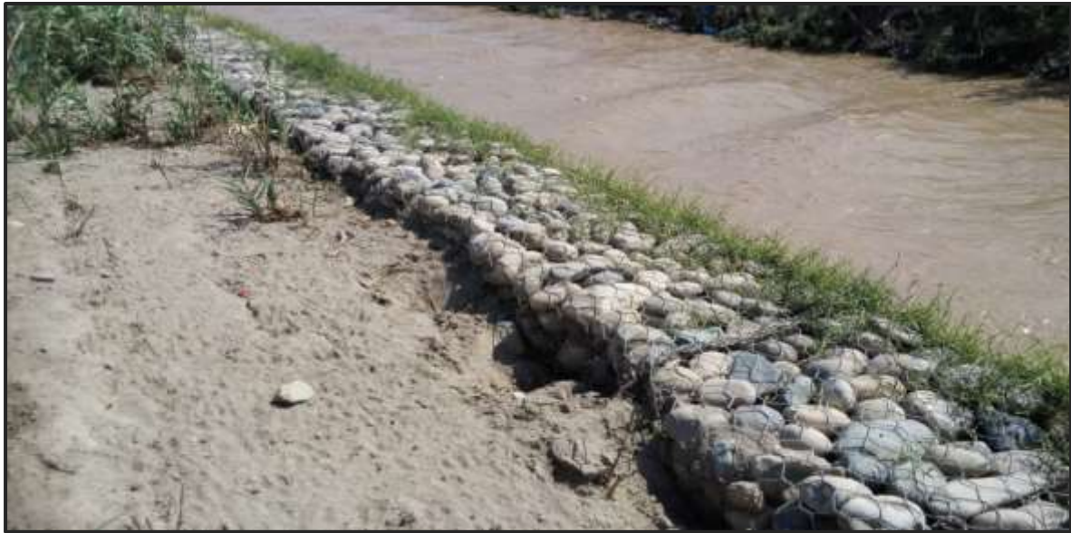
Descripción de Foto N° 08: El uso de Gaviones como medidas estructurales para la mitigación del riesgo por inundación de la margen derecha del río Ica. Enero 2017.
