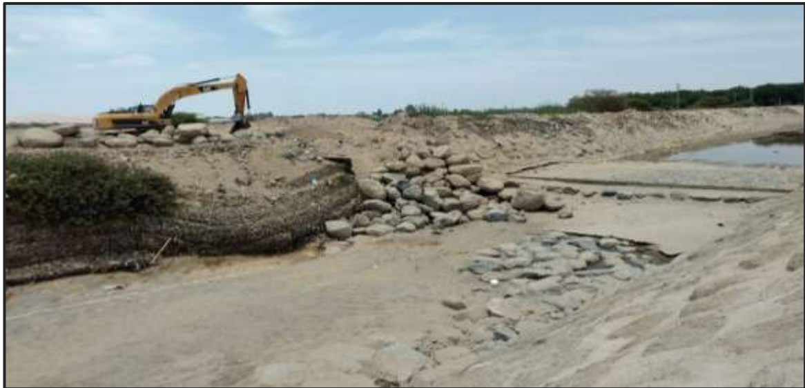
Descripción de Foto N° 09: Ejecución de enrocado y eliminación de Gavión colapsado en el punto crítico identificado, en la margen derecha del Río Ica, sector La Poruma. Bocatoma. Febrero 2018.
