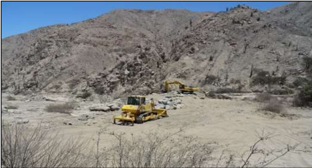
Descripción de Foto N° 12: Rehabilitación de diques en la Kansas del distrito de La Tinguiña
