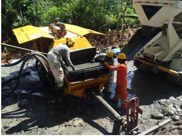
13 Bombo de Concreto.
