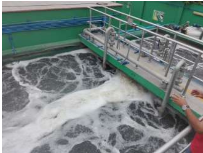
Figura 19. Planta de Tratamiento de Aguas Residuales, María Reiche
