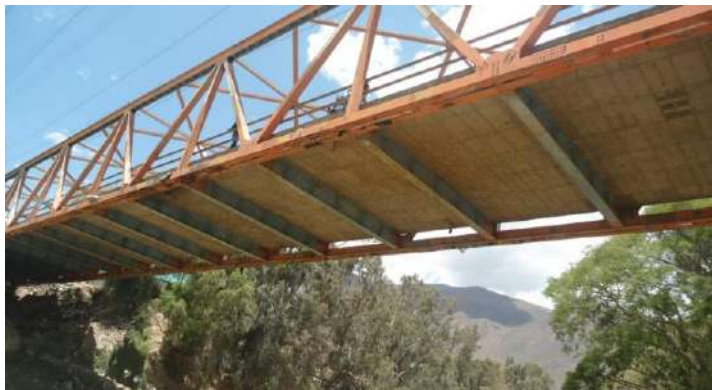
NERO UBICADO EN LA PARTE INFERIOR DE LA ESTRUCTURA RETICUL
