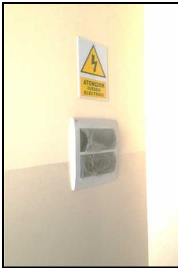
FOTO 10. PELIGRO ELECTRICO: CONTACTO ELECTRICO
