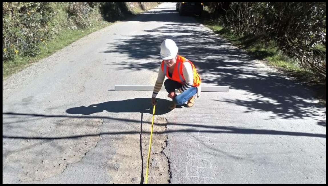
Anexo 1.9: Medición de longitud de fallas
