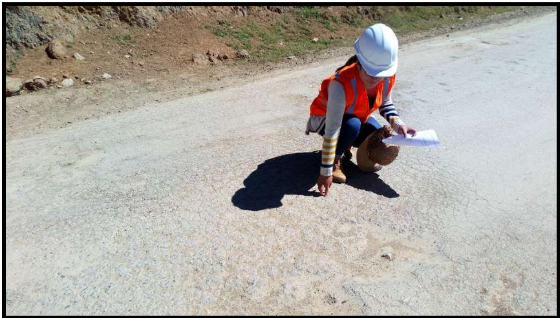
Anexo 1.6: Identificado de tipo de fallas
