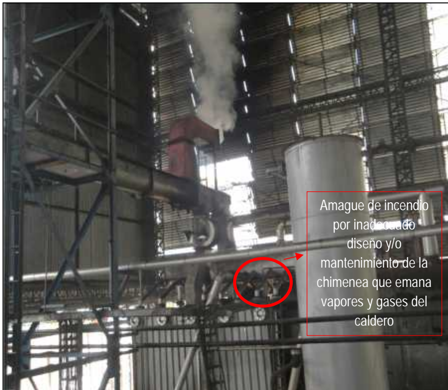
Imagen N° 12: Amague de incendio en chimenea de caldero por inadecuado diseño y/o mantenimiento. Fuente: Elaboración propia, 2015
