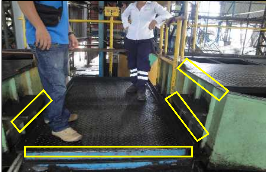
Imagen N° 05: La textura de las plataformas antideslizantes presentan una capa oleosa, que se evidencia en toda la planta, además de la falta de señalización en los peldaños.
