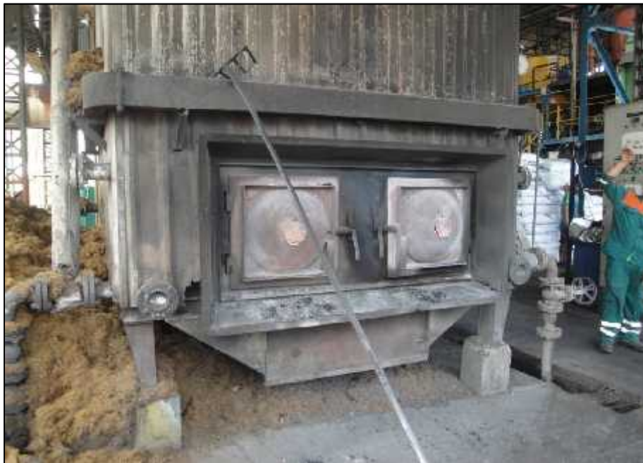
Imagen N° 08: Caldero. No se cuenta con adecuada señalización y delimitación de las zonas y espacios de trabajo, tránsito peatonal y vehicular, en toda la planta. Fuente: Elaboración propia, 2015
