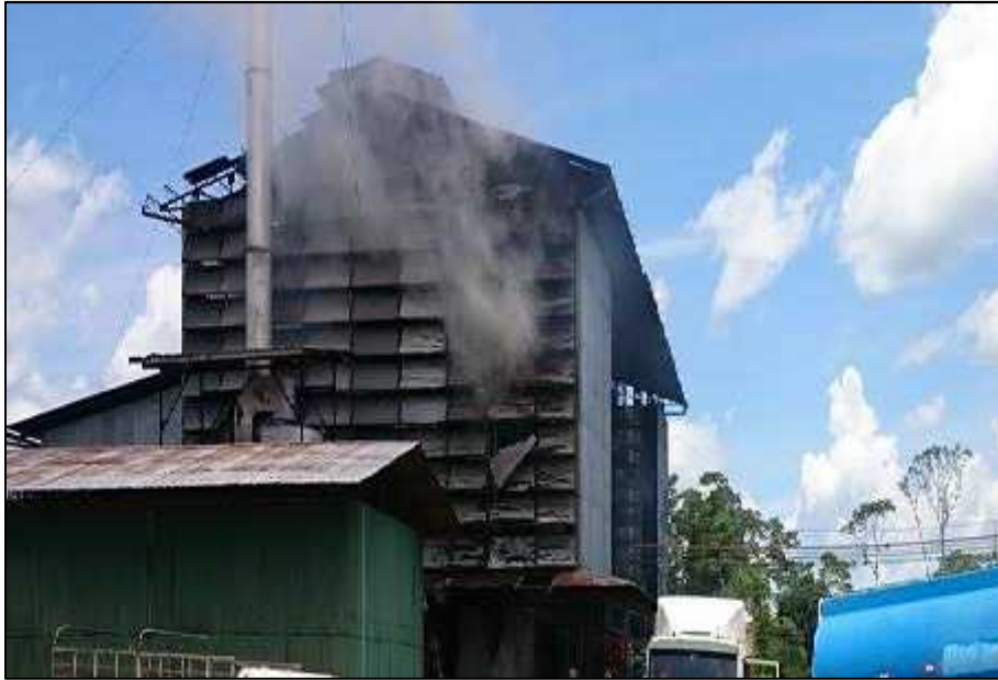
Imagen N° 07: Infraestructura del techo de la planta en deficiente estado; además, se muestra el inadecuado sistema de tratamiento emisiones. Fuente: Elaboración propia, 2015.
