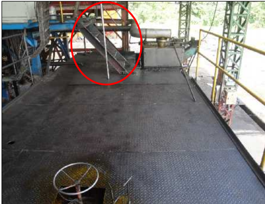
Imagen N° 04: Escalera sin pasamanos y las que se encuentran, presentan una textura oleosa, el cual es un peligro latente.
