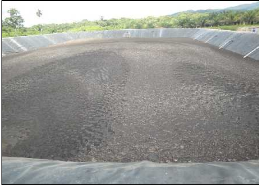
Imagen N° 11: Planta de Tratamiento de Aguas Residuales, Lodos Facultativos. Fuente: Elaboración propia, 2015
