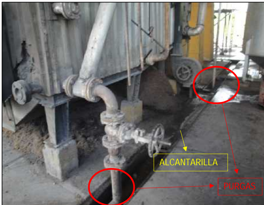
Imagen N° 06: Caldero, se señala las purgas y las alcantarillas sin protección alguna ni señalización, a pesar que al momento de purgar se libera vapor de agua a altas temperaturas.
