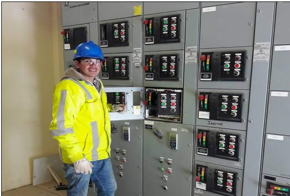
Figura 34: Verificación del encendido de los equipos en la planta San Pedro.
