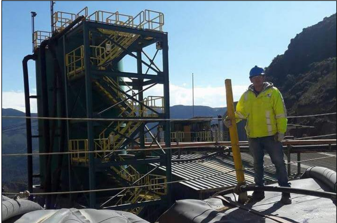
Figura 35: Clarificador 2 de la planta San Pedro.
