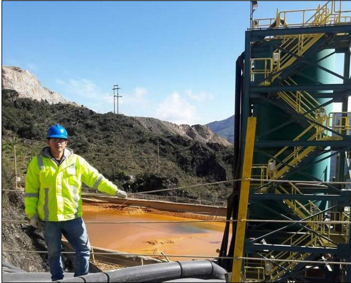
Figura 33: Clarificador 1 de la planta San Pedro.
