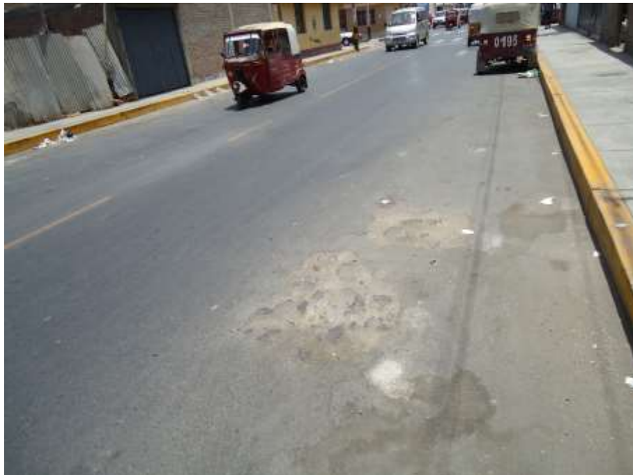
Figura N° 02: Agrietamiento Vista Fotográfica.
