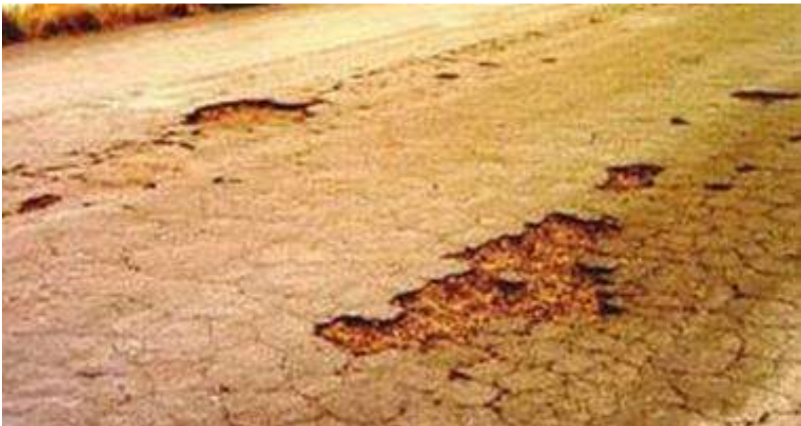
Fisuras y grietas por fatigamiento.
