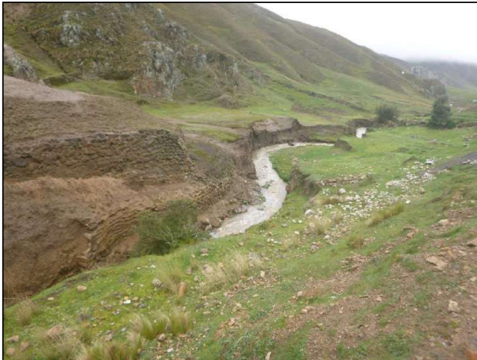
Fotografía 11 Vista de los taludes deteriorados del DR N°3
