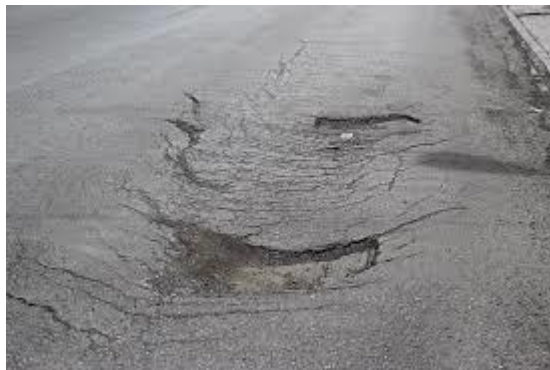
Figura 02 Desprendimiento de la última capa delgada
