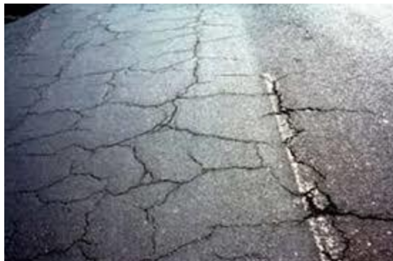
Figura 03 Agrietamiento (Piel de cocodrilo)
