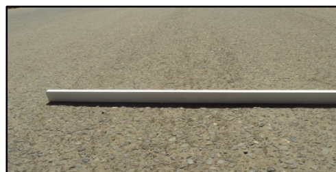
Figura 13: Pérdida de la película de ligante Fuente: Elaboración propia.
