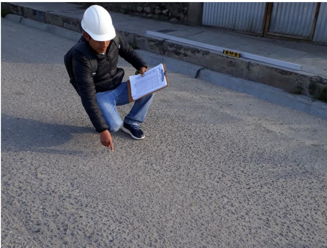
Fotografía 8: Se ilustra en la imagen el registro de campo de la pérdida de agregados.
