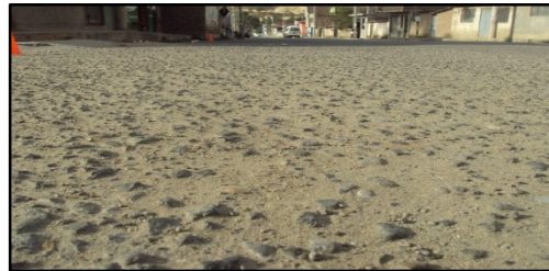
Figura 14: Pérdida de agregados Fuente: Elaboración propia.
