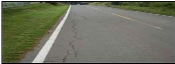
Figura 10: Fisuras de borde
