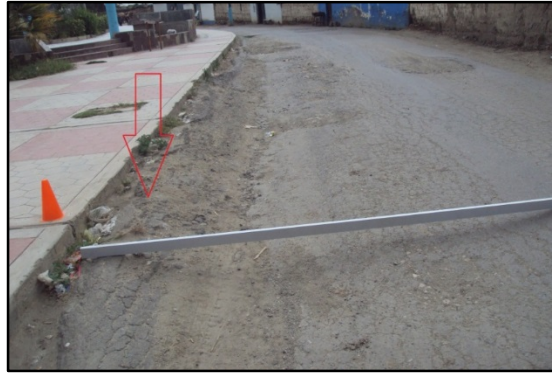
Figura 12: Desplazamiento o abultamiento de la mezcla Fuente: Elaboración propia.
