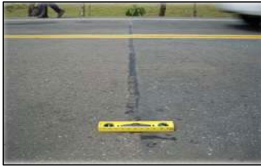
Figura 7: Fisura transversal de junta de construcción
