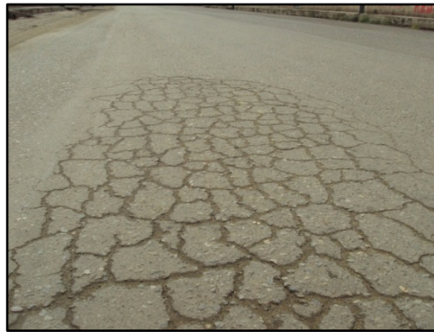
Figura 5: Fisuras piel de cocodrilo
