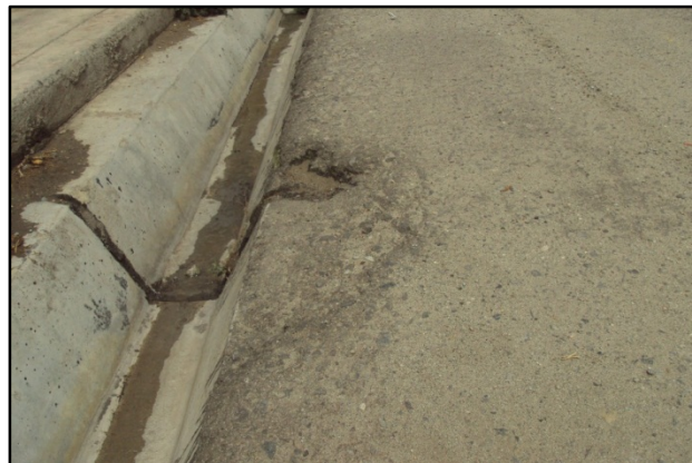
Figura 23: Erosión de bermas
