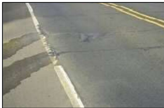
Figura 19: Afloramiento de agua
