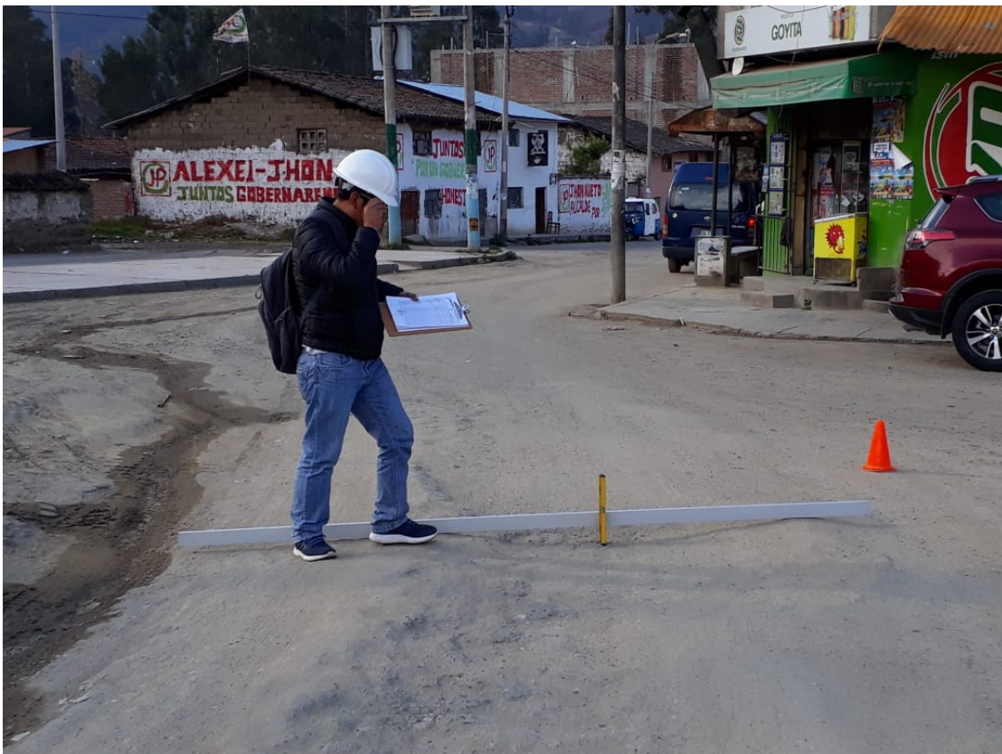
Fotografía 2: Se observa la medida de nivel de gravedad de la depresión longitudinal.
