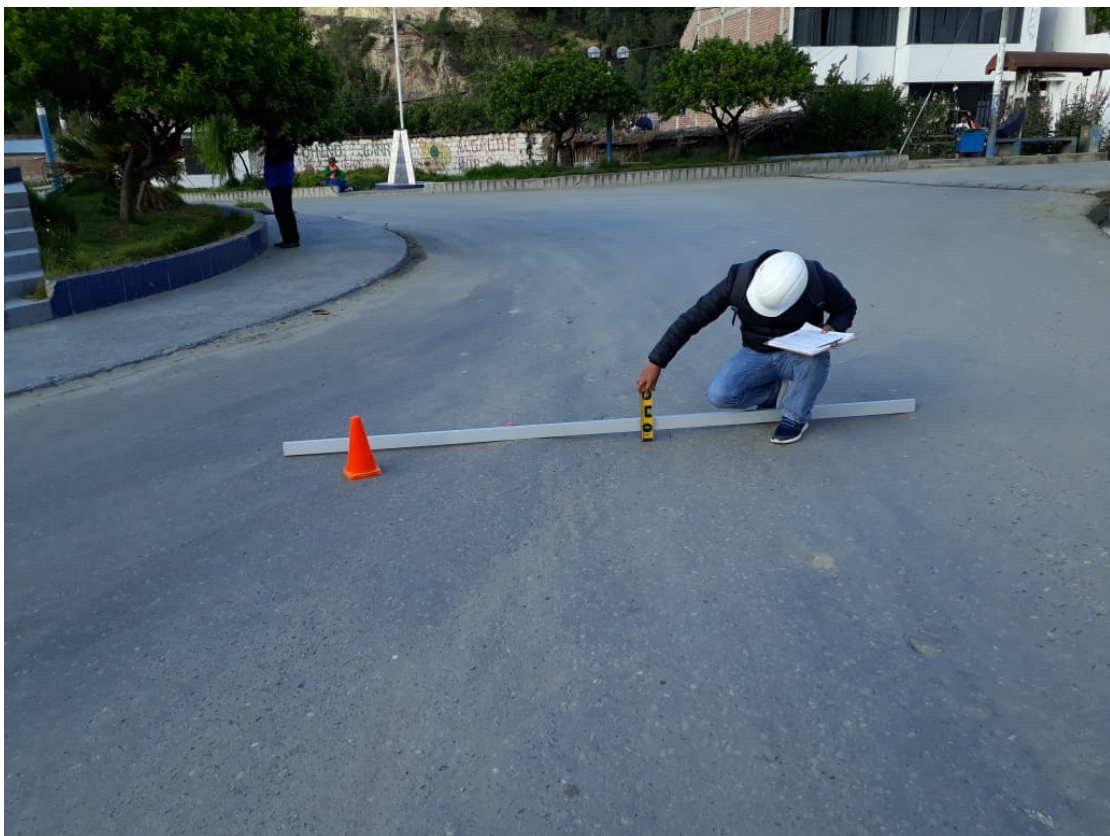
Fotografía 4: Se observa en la imagen la medida de la depresión longitudinal.
