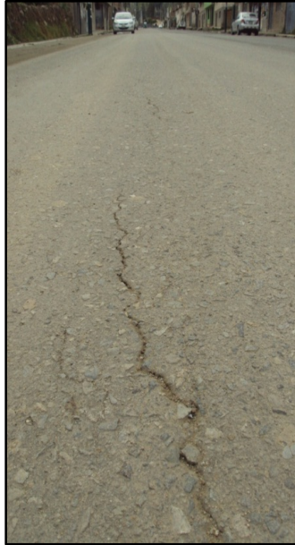
Figura 8: Fisuras de contracción térmica
