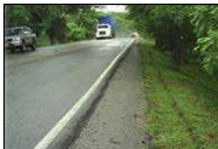
Figura 21: Escalonamiento entre calzada y berma
