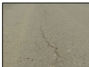
Figura 4: Fisuras longitudinales por fatiga
