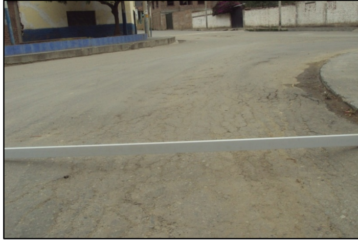
Figura 3: Depresiones o hundimientos longitudinales
