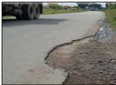
Figura 20: Desintegración de los bordes del pavimento
