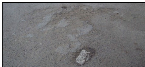
Figura 15: Descascaramiento Fuente: Elaboración propia.
