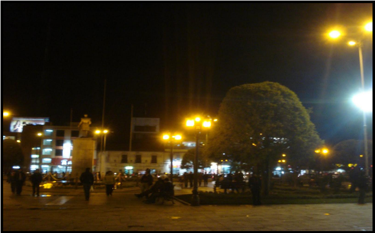
Luminarias direccionadas hacia arriba, lo cual su flujo debe ser hacia abajo.
