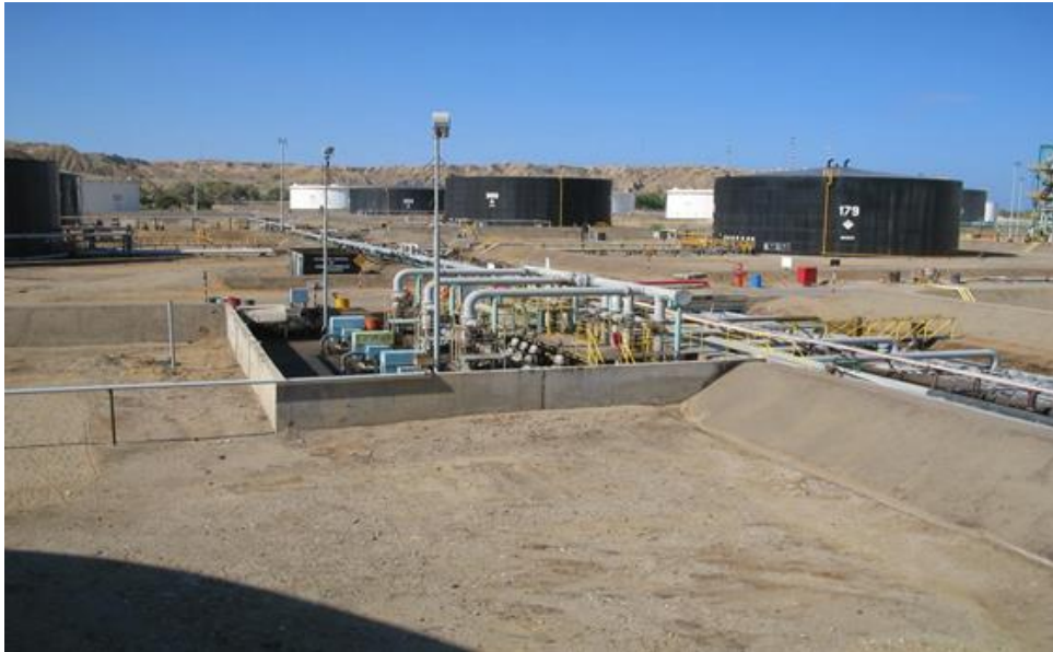
Figura 12 Casa de Bombas N°7
