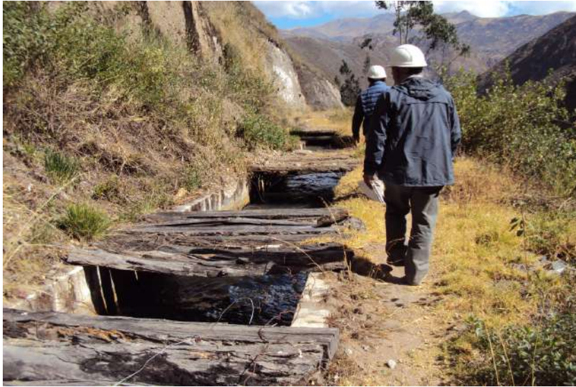
Figura n° 16: Vigas de madera deteriorada las mismas que van a ser cambiadas.
