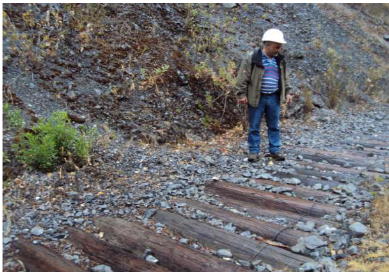
Figura n° 15: Viga de madera que protege el canal.
