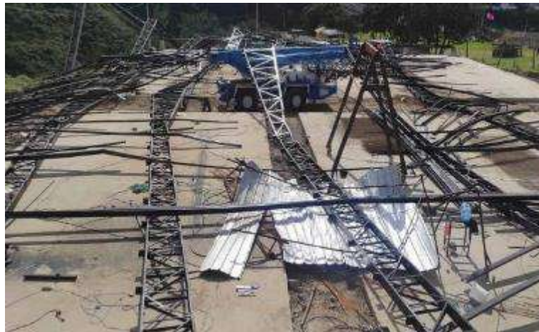
Estructura Metálica en el Piso
