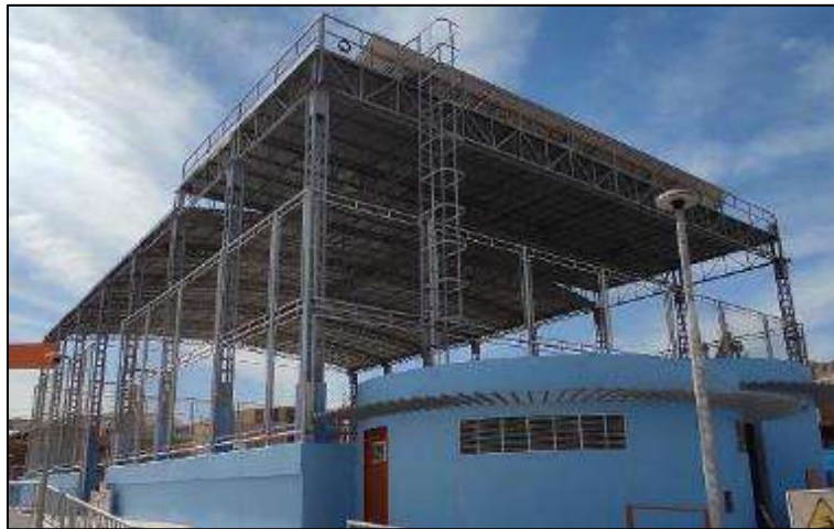
Imagen 8 Estructura Metálica Liviana 8
