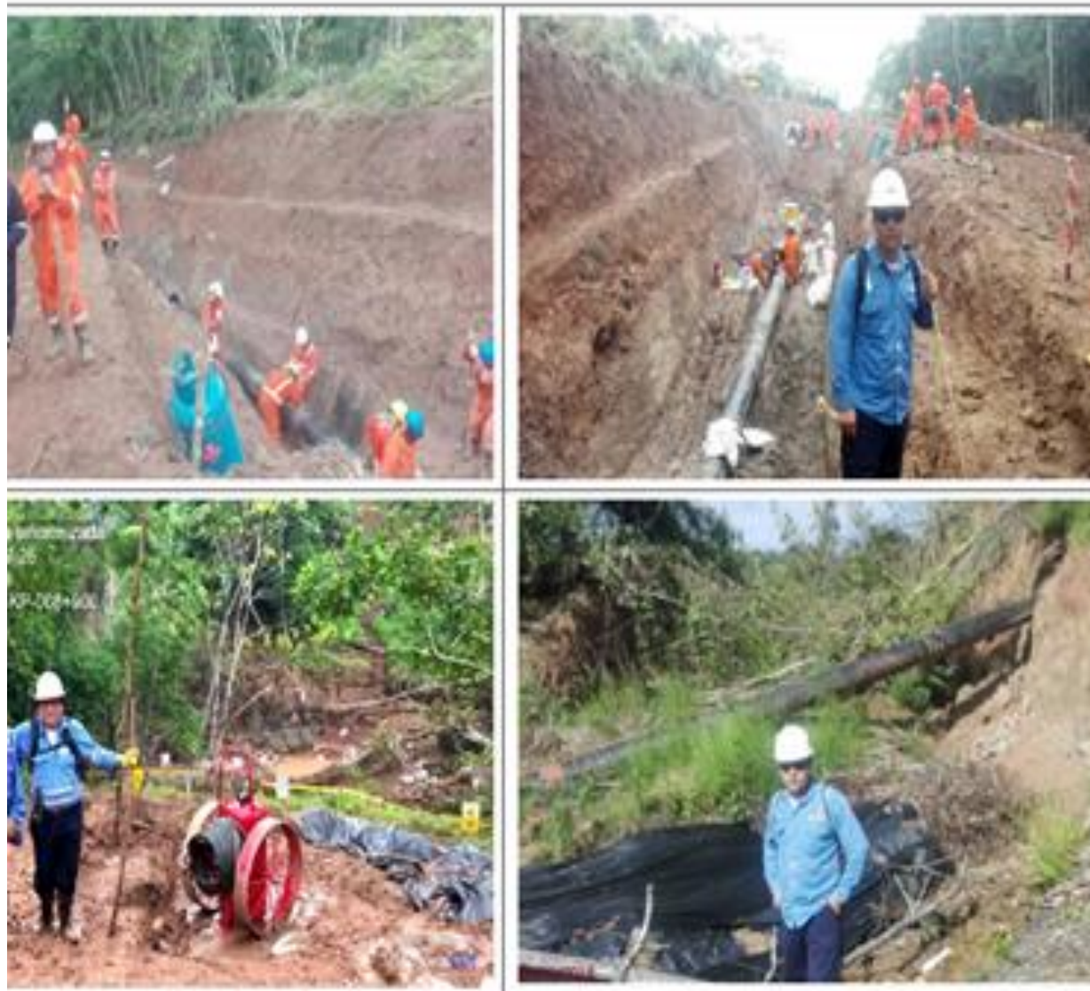
16, 17, 18, 19 y 20: Vista de la presencia permanente de Osinergmin en la zona del incidente.
