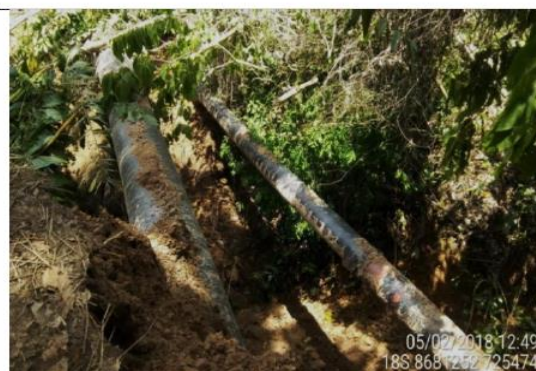
Imagen 04: KP 09+070, Vista de tuberías expuestas de GN y LGN, en una longitud de 10 metros. (05.02.2018)
