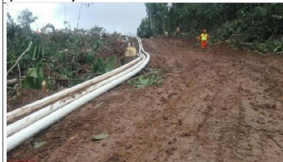
Imagen 24: Vista del tendido de las tres (03) líneas de tubería flexible de 6", a lo largo de la variante. (14.02.2018)
