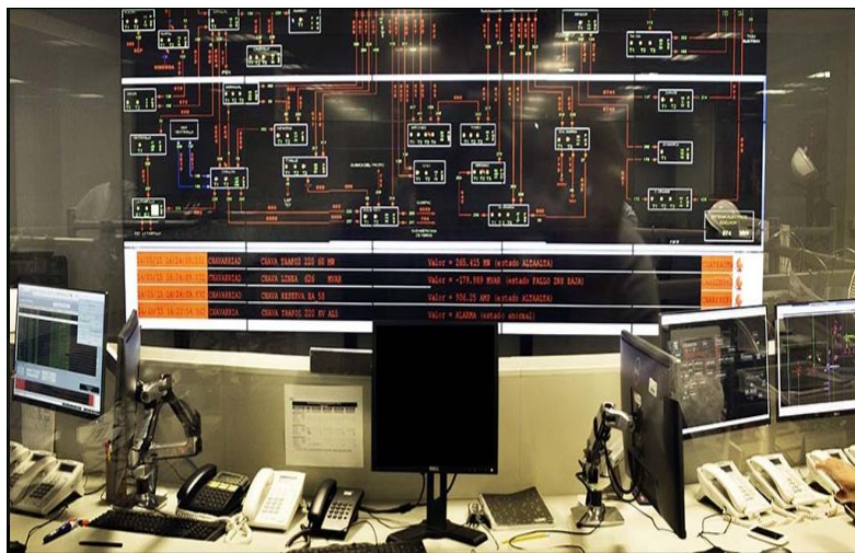
Características del Sistema Scada
