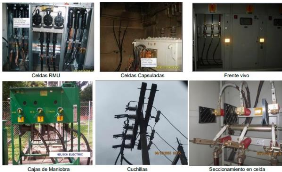
Equipos y Celdas de Maniobra
