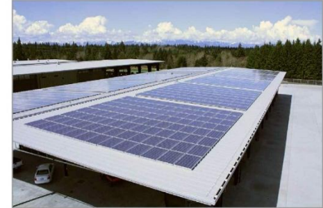
PANELES SOLARES EN LOS TECHOS DE LOS TALLERES DE MANTENIMIENTO
