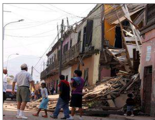
Fig.7 Desplome de vivienda, Rímac
