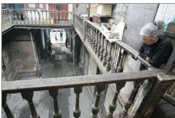
Fig.6 Inaceptables condiciones de habitabilidad
