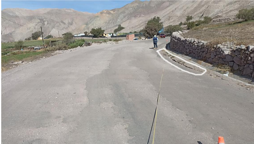
Foto 2. Se presentan los daños por hundimiento con mayor gravedad en la calzada derecha en la U/M 08 de la vía TA-104 del km 2+000 al 3+000, región de Tacna. Fuente: Elaboración propia.
