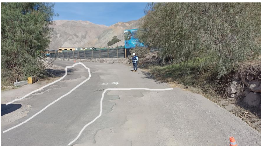
Foto 7. Se presentan la patología de huecos con mayor severidad en la calzada derecha en la U/M 09 de la vía TA-104 del km 2+000 al 3+000, región de Tacna. Fuente: Elaboración propia.
