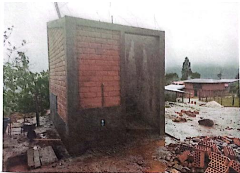
Foto 4 Unidad Básica de Saneamiento
