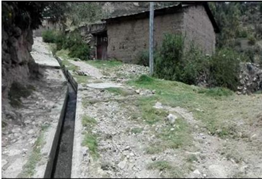
Fotografía 4. Sistema de drenaje de agua pluvial abierto a la intemperie, provocando la obstrucción por residuos sólidos
