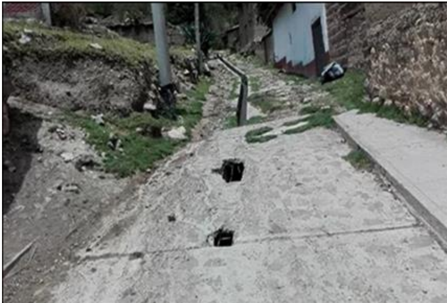
Fotografía 3. Sistema de drenaje de agua pluvial abierto a la intemperie, provocando la obstrucción por residuos sólidos
