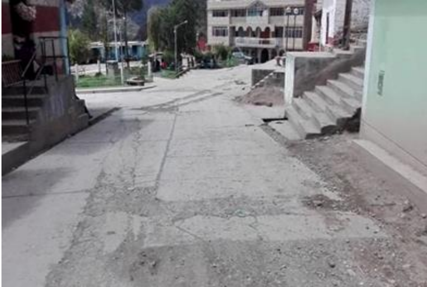
Fotografía 12. Se aprecia las graderías en pésimas condiciones para los peatones.
