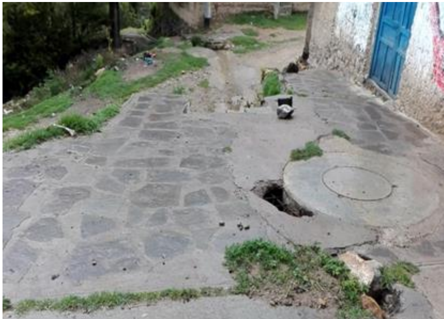
Fotografía 5. Sistema de drenaje de agua pluvial abierto a la intemperie, provocando la obstrucción por residuos sólidos y es un peligro para los peatones.
