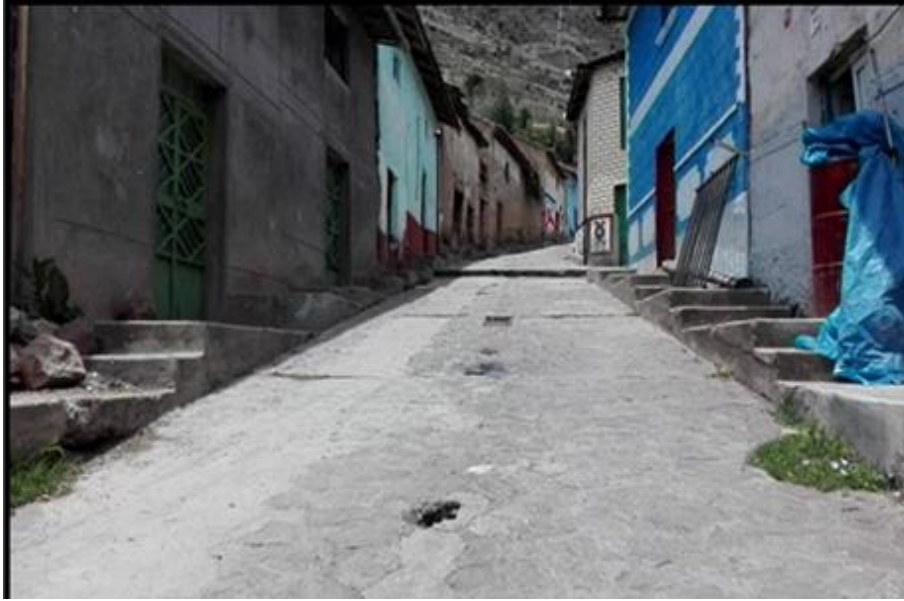
Fotografía 2. El Jr. San Martín se aprecia en pésimas condiciones
