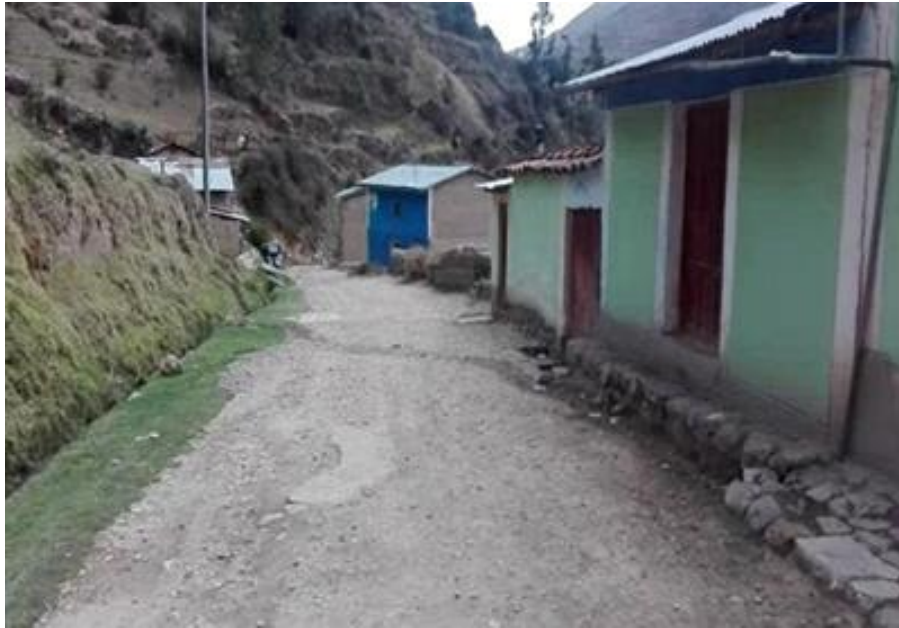
Fotografía 8. Se aprecia las veredas que no permiten el libre tránsito de los peatones los cuales en temporadas de precipitaciones es intransitable.
