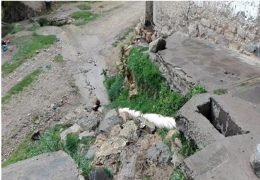
Fotografía 6. Sistema de drenaje de agua pluvial abierto a la intemperie, provocando la obstrucción por residuos sólidos y es un peligro para los peatones.
