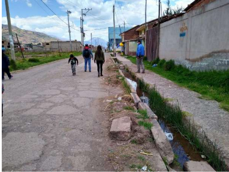
Foto 2. Vía con deficiente sistema de evacuación de aguas pluviales
