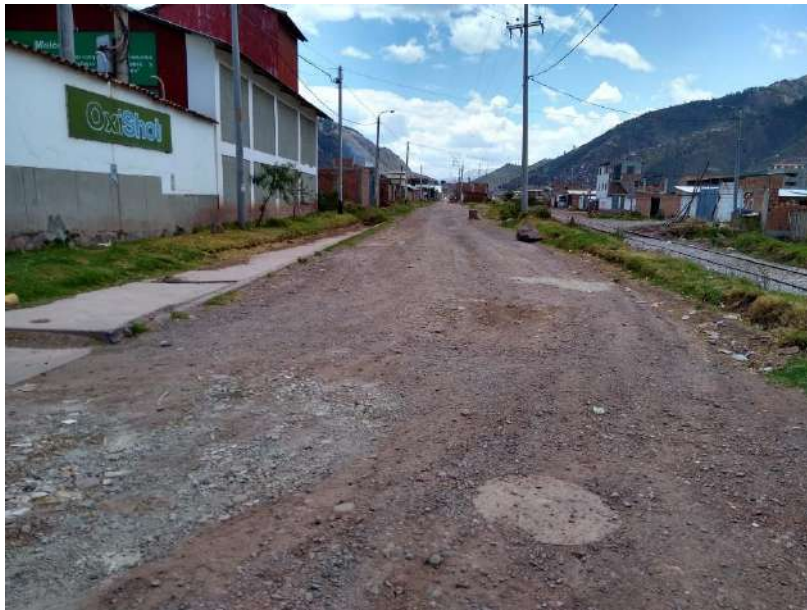
Foto 3. Via con veredas deterioradas
