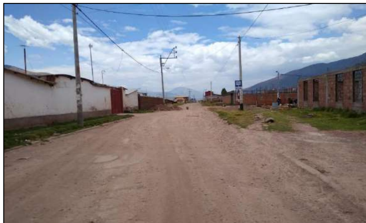
Foto 1. Vista de pavimento deteriorado
