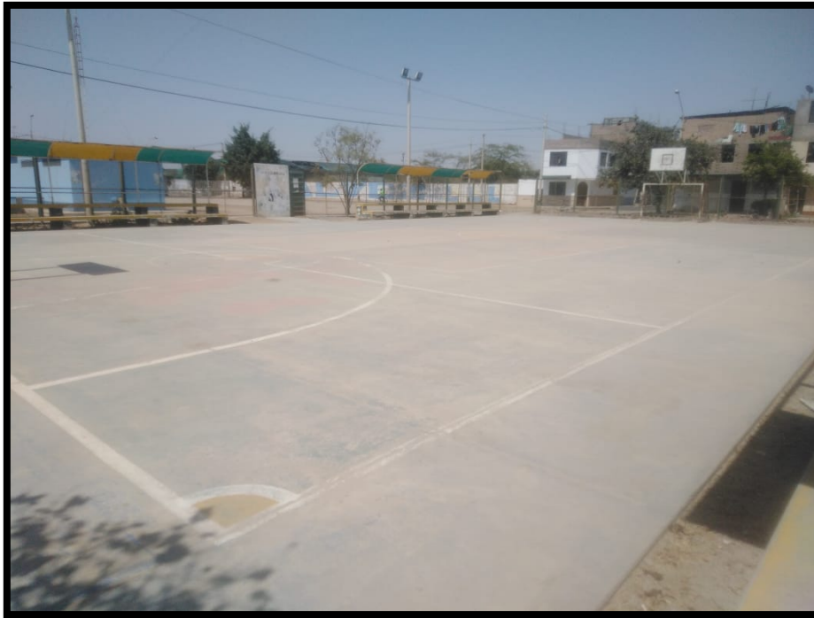
Foto 02 – Estado Situacional de Losa
