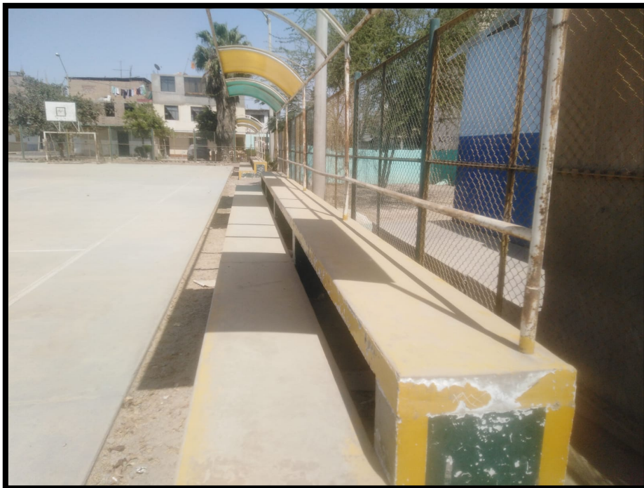
Foto 03 – Estado situacional de Gradass
