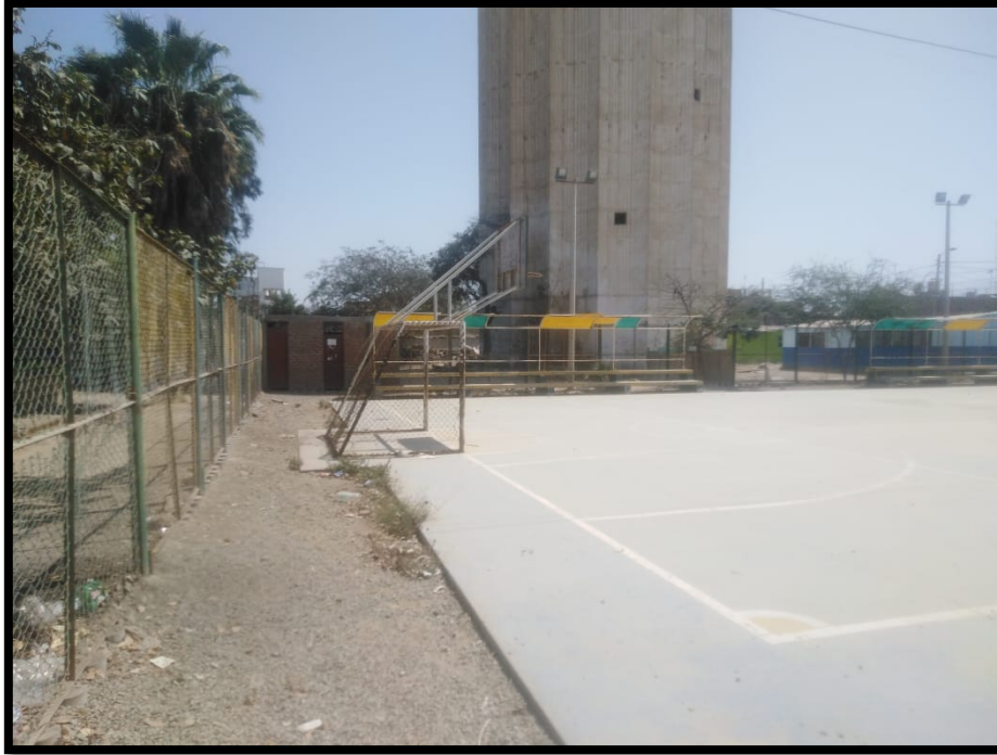
Foto 04 – Estado Situacional de rejas exteriores
