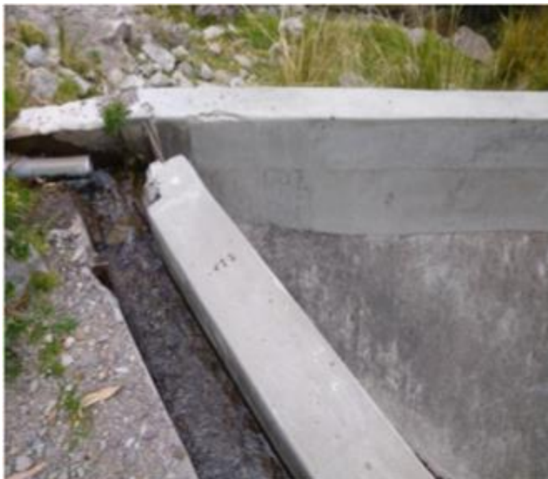
Fotografía 3 Entrada de agua al desarenador
