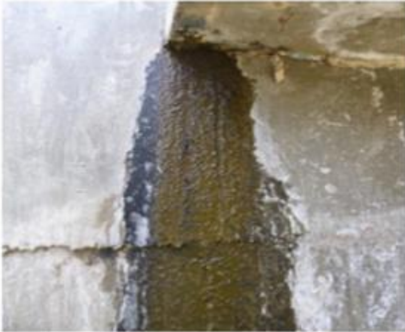
Fotografía 7 Filtración del reservorio
