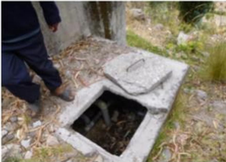
Fotografía 8 Estado deteriorable de la aducción
