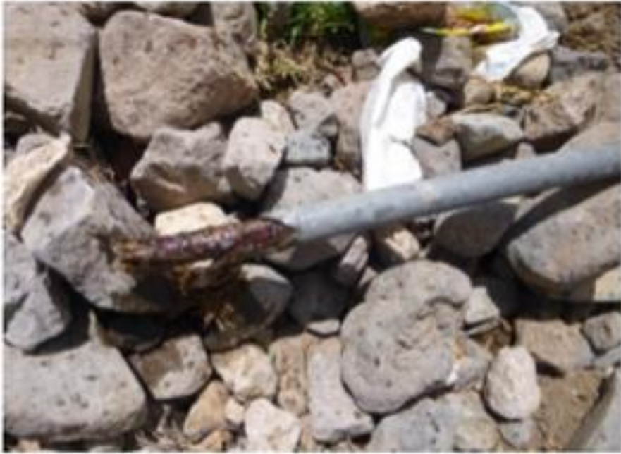
Fotografía 11 Estado de las redes primarias
