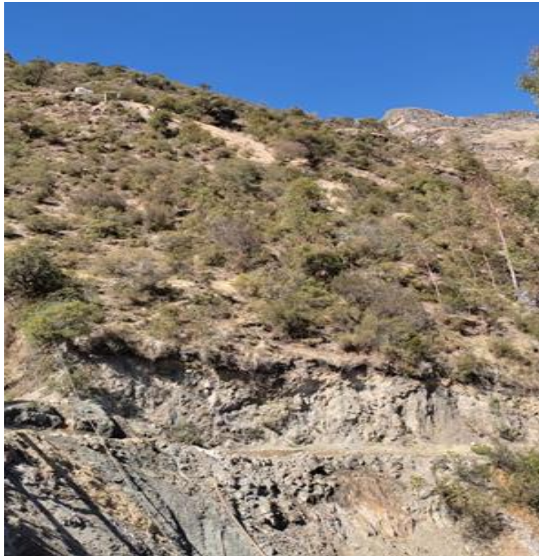
Imagen N° 4 - Carreteras sin sistema de drenaje
