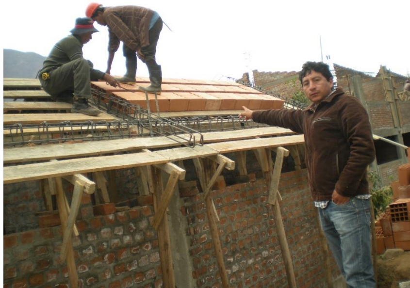
COLOCADO DE BLOQUETAS DE ARCILLA PARA TECHO EN LOS SS.HH. TRABAJADORES SIN USO DE ARNES Y EPPS BASICOS PARA DICHO TRABAJO
