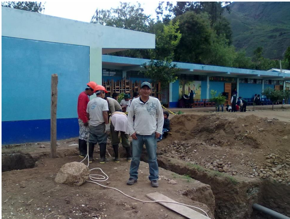
INGENIERO RESIDENTE VERIFICANDO EL TRABAJO SIN USO DE INPLEMENTOS DE SEGURIDAD
