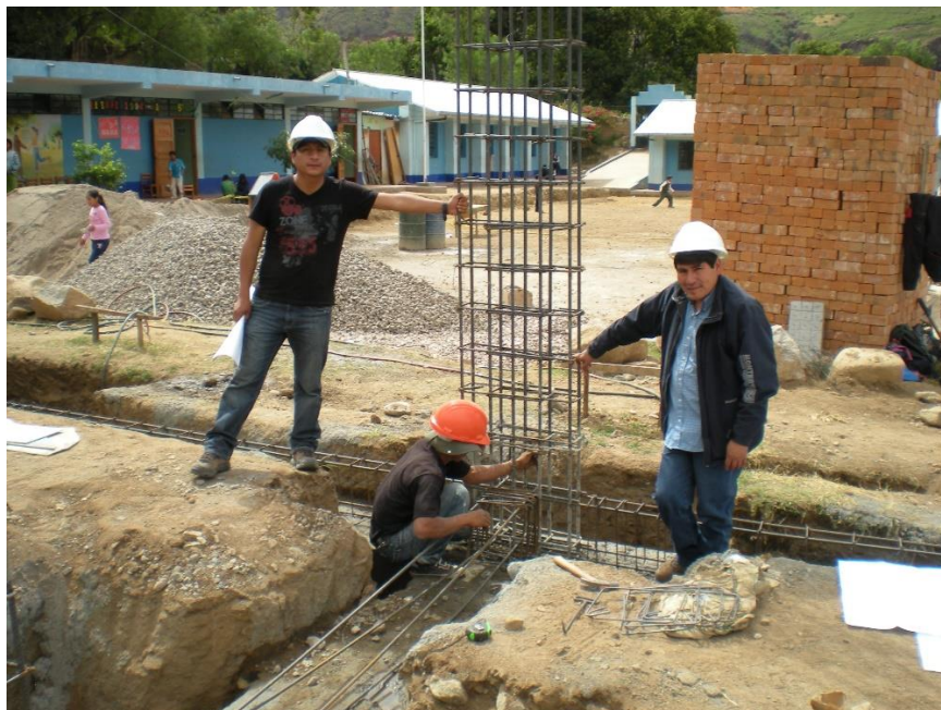
RESIDENTE Y SUPERVISOR DE LA OBRA VERIFICANDO LOS TRABAJOS DE HABILITADO DE LAS VIGAS DE CIMENTACIÓN. TRABAJADOR SIN WANTES NI BOTAS DE SEGURIDAD.
