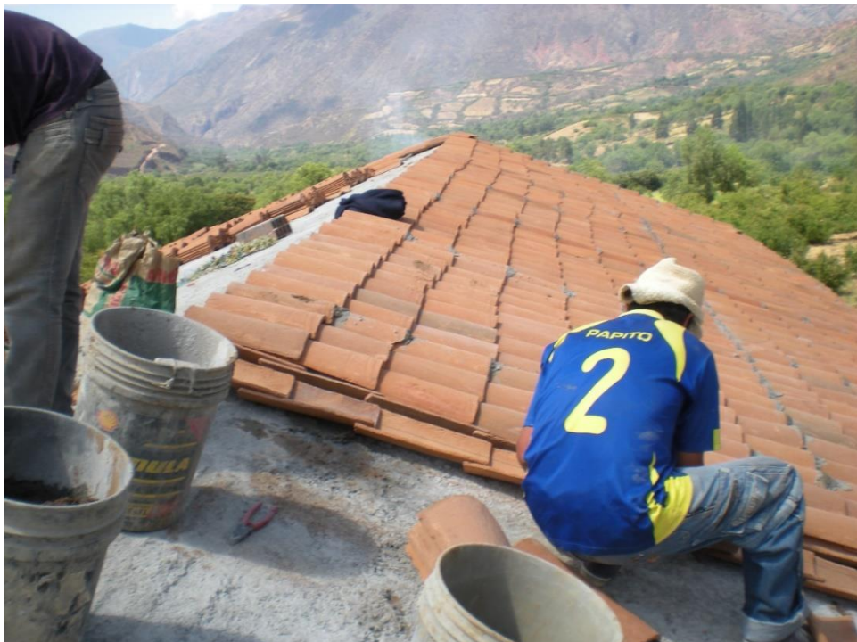
COBERTURA CON TEJA DE ARCILLA COCIDA EL LOS SS.HH.TRABAJADOR SIN USO DE ARNES DE SEGURIDAD
