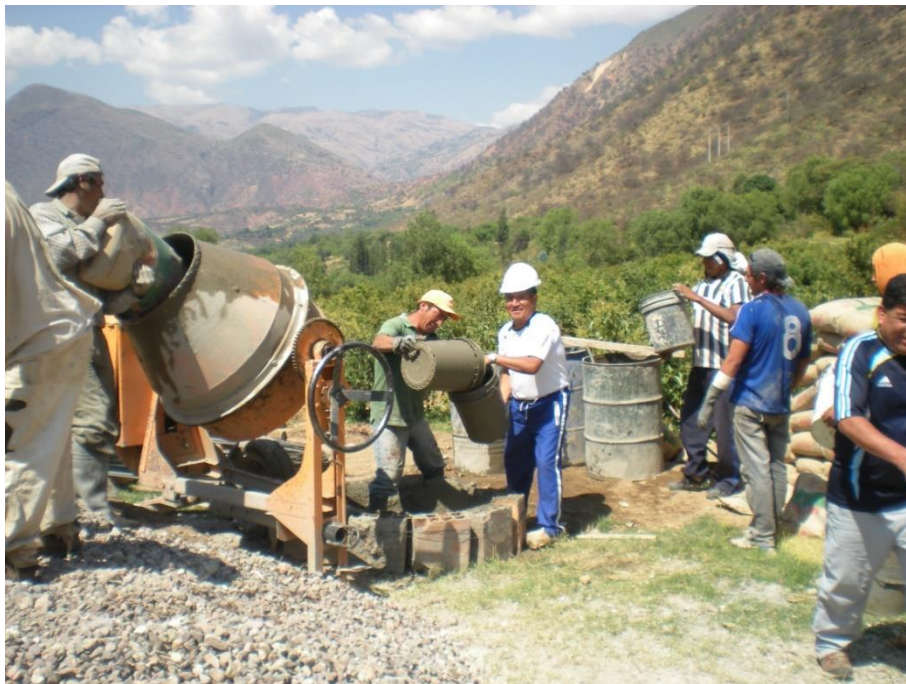
PREPARACION DEL CONCRETO F' C=210 KG/CM2 PARA EL VACIADO DE VIGAS. TOTAL DESORDEN FALTA DE USO DE EPPS, CONTAMINACION AMBIENTAL
