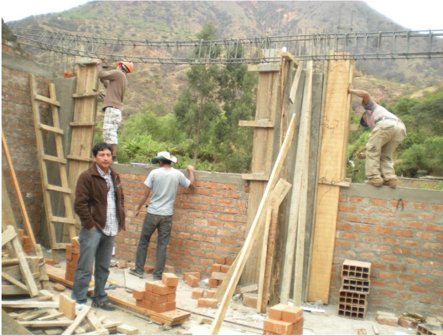
ENCOFRADO Y VACIADO DE COLUMNAS DEL SEGUNDO PISO.INGENIERO Y TRABAJADORES EN UN TOTAL DESORDEN SIN USO DE LOS EPPS DE SEGURIDAD, SALUD Y MEDIO AMBIENTE.
