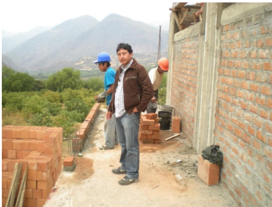
ASENTADO DE MURO EN PASADIZO DE SEGUNDO PISO. SIN EL USO DE EPPS
