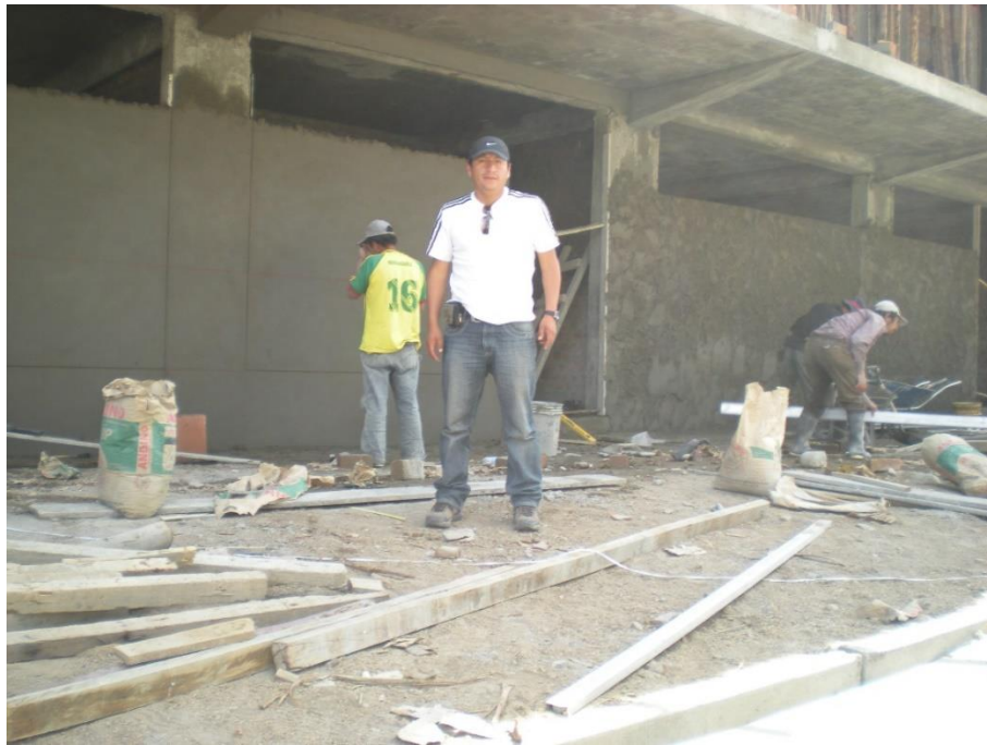
RESIDENTE DE OBRA VERIFICANDO EL TARRAJEO DE LOS MUROS EXTERIORES SIN NINGUNA PROTECCION DE SEGURIDAD
