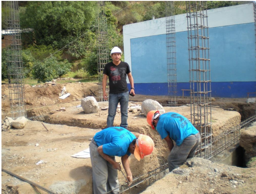
TRABAJADORES HABILITANDO VIGAS DE CIMENTACIÓN SIN EPP BÁSICOS PARA REALIZAR DICHO TRABAJO
