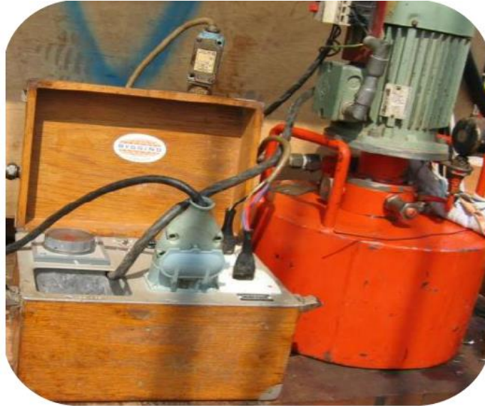
Imagen N° 36: Bomba de aceite- dispositivo control automático.
