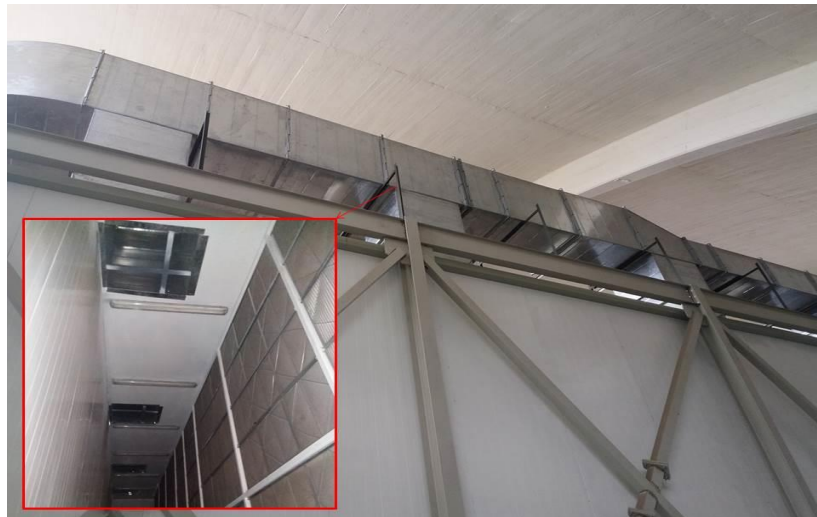
Figura N°11: Canales de flujo de aire de las ventiladoras
