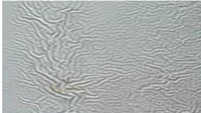
Figura N°6: Arrugas de pintura
