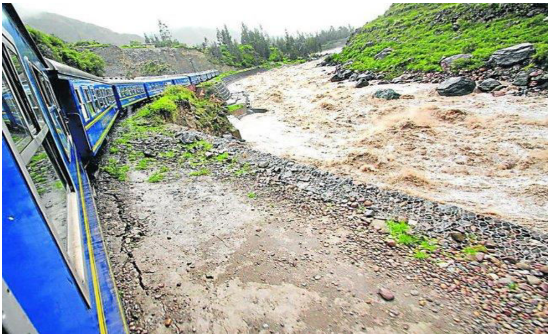
Imagen N° 014: Se puede apreciar en esta imagen el derrumbe a la altura del Km. 104.7 con dirección al Santuario de Machu Picchu (2013)
