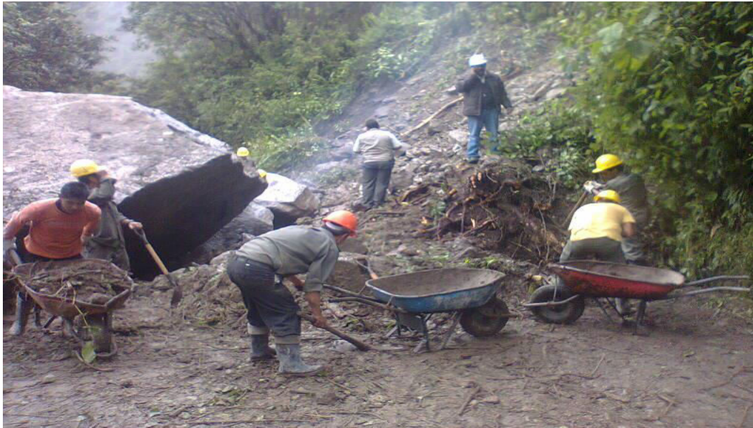
Imagen N° 015: En esta imagen se aprecia el derrumbe ocurrido en el Km. 104.7 a la carretera de acceso a Machu Picchu
