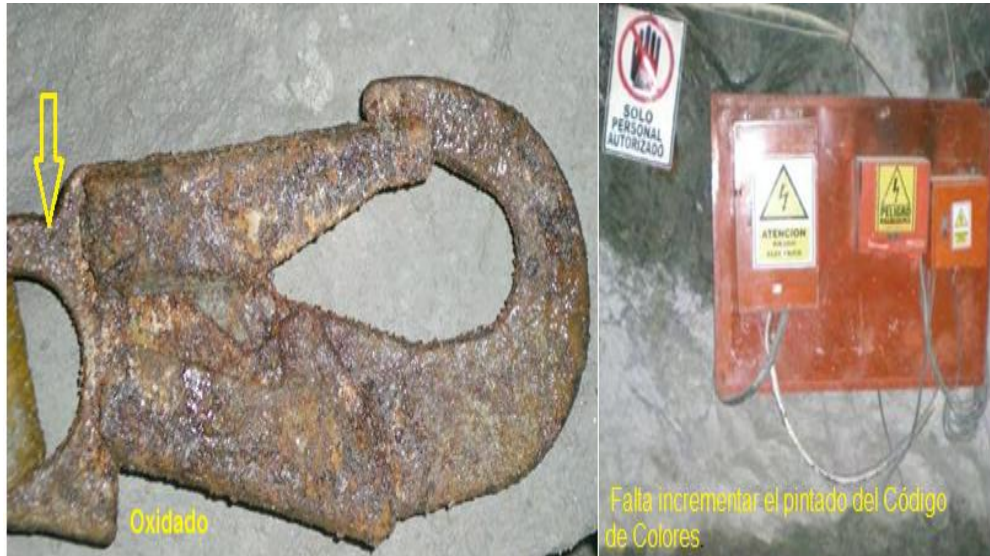
Figura 30. Riesgos encontrados en los equipos Fuente: Elaboración propia, 2017.
