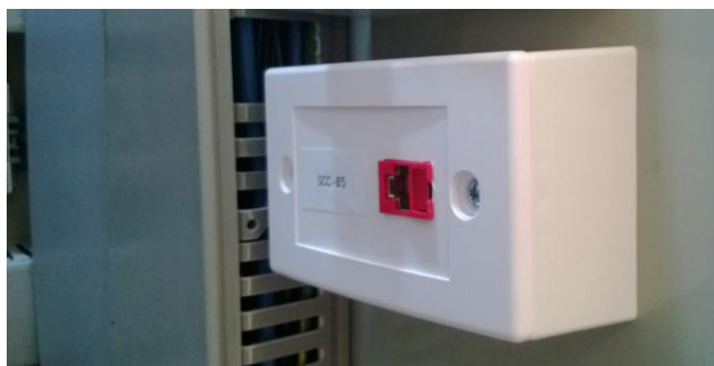
Figura 9: Caja superficial en gabinetes
