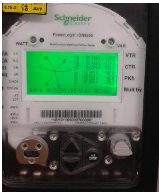
Figura 6: Medidor de energía Schneider Electric, modelo ION 8650
