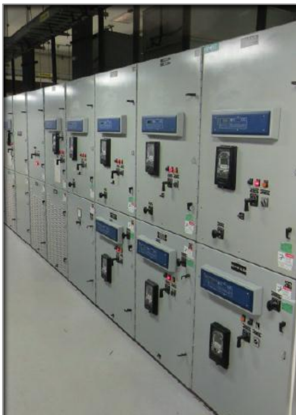
Figura 33: Vista de SE Principal
