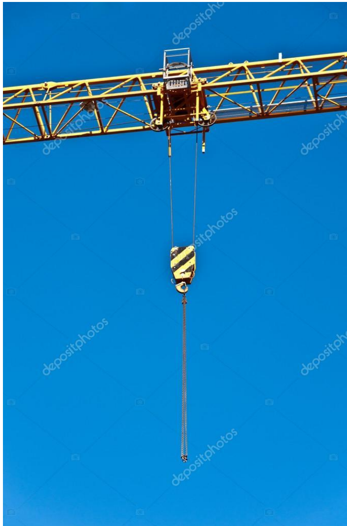
Foto 6: Carro, gancho y cable de grúa torre
