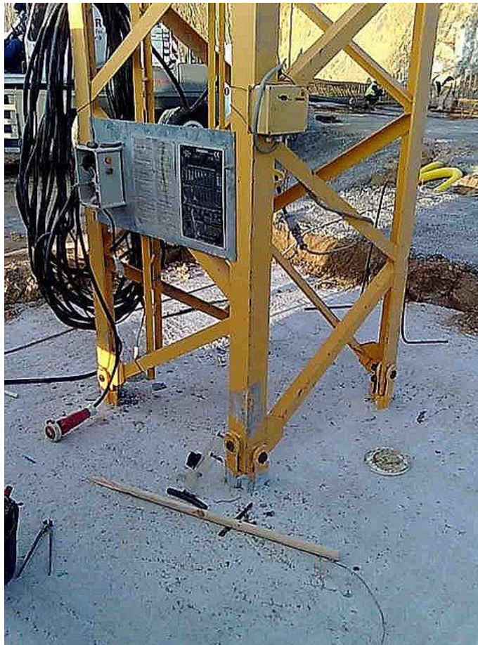
Foto 5: Lastre de grúa torre (zapata enterrada)
