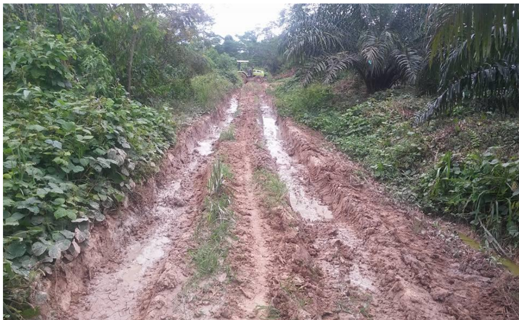
Gráfico N°1 : Deformaciones longitudinales de las carreteras al interior de la plantación de palma aceitera en la empresa Agropecuaria Rossel
