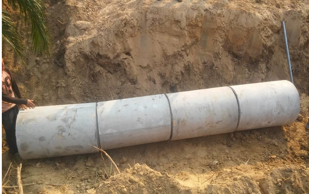
Gráfico N° 9: Colocación de tubos de concreto para la construcción de puentesa en las carreteras al interior de la plantación de palma aceitera en la empresa Agropecuaria Rossel
