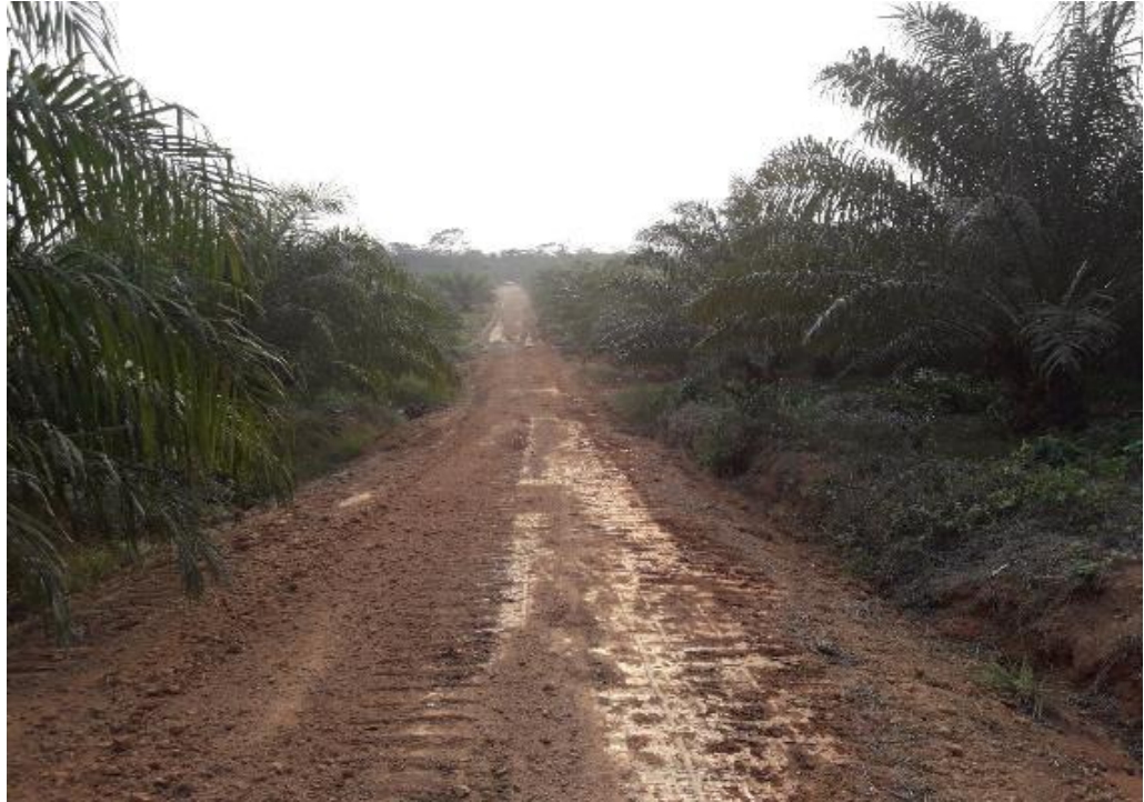
Gráfico N° 7: Perfilado y cuneteado de las carreteras al interior de la plantación de palma aceitera en la empresa Agropecuaria Rossel
