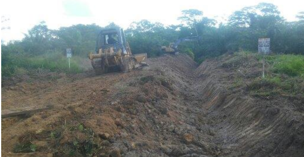
Foto N° 7: La limpieza y ampliación de las zanjas naturales fueron primordiales para garantizar una mejor conservación de las vías.
