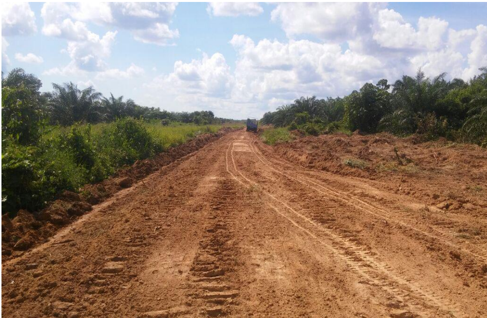
Foto N° 6: Para ampliar el ancho de las calzadas se requirió movimiento de considerables volúmenes de tierra.
