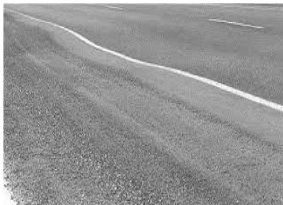
Figura II.6. La falla Abultamientos y hundimientos
