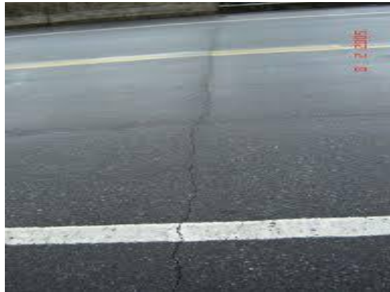
Figura II.8. La falla longitudinal y transversal
