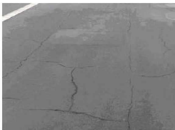
Figura II.5. La falla agrietamiento de bloque
