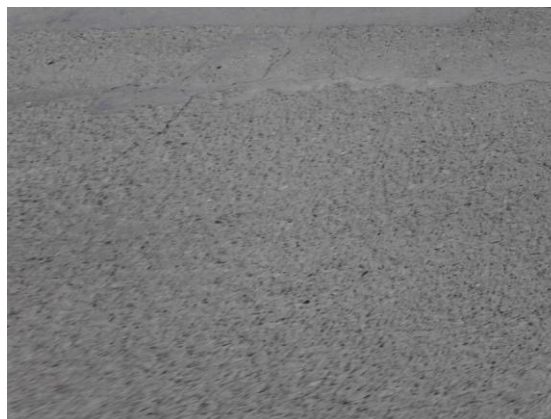
Figura II.7. La falla por Corrugación
