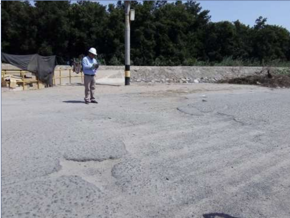
DISGREGACIÓN DEL MATERIAL GRANULAR
