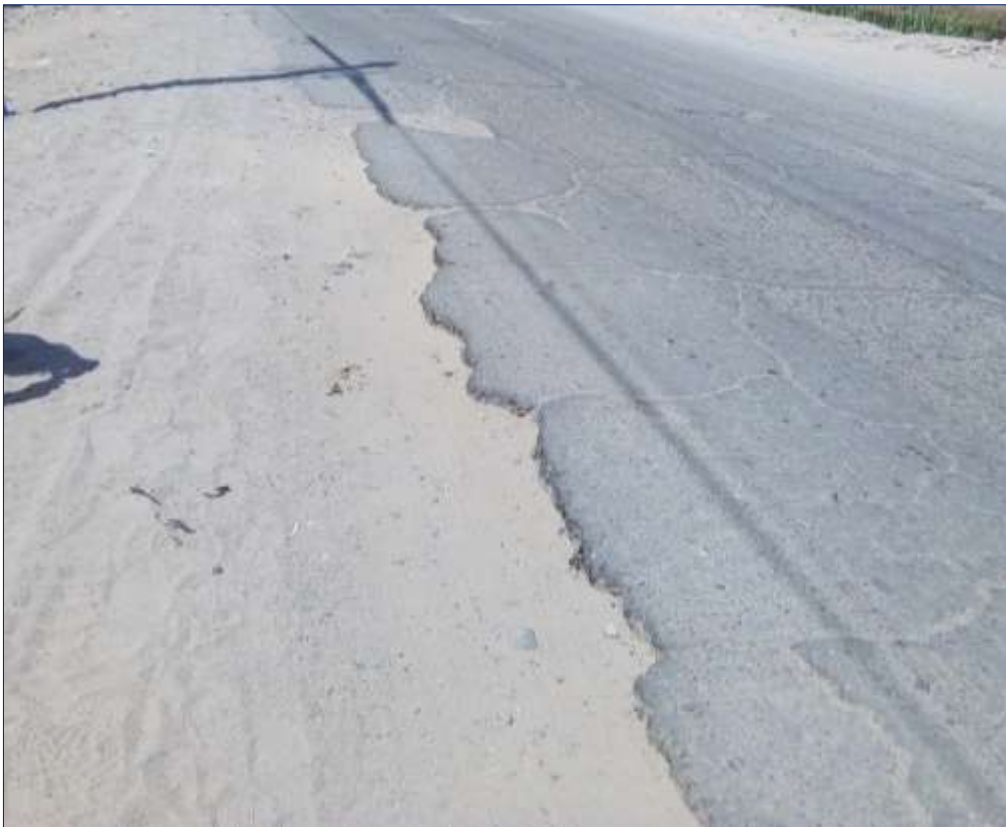
DISGREGACIÓN DEL BORDE
