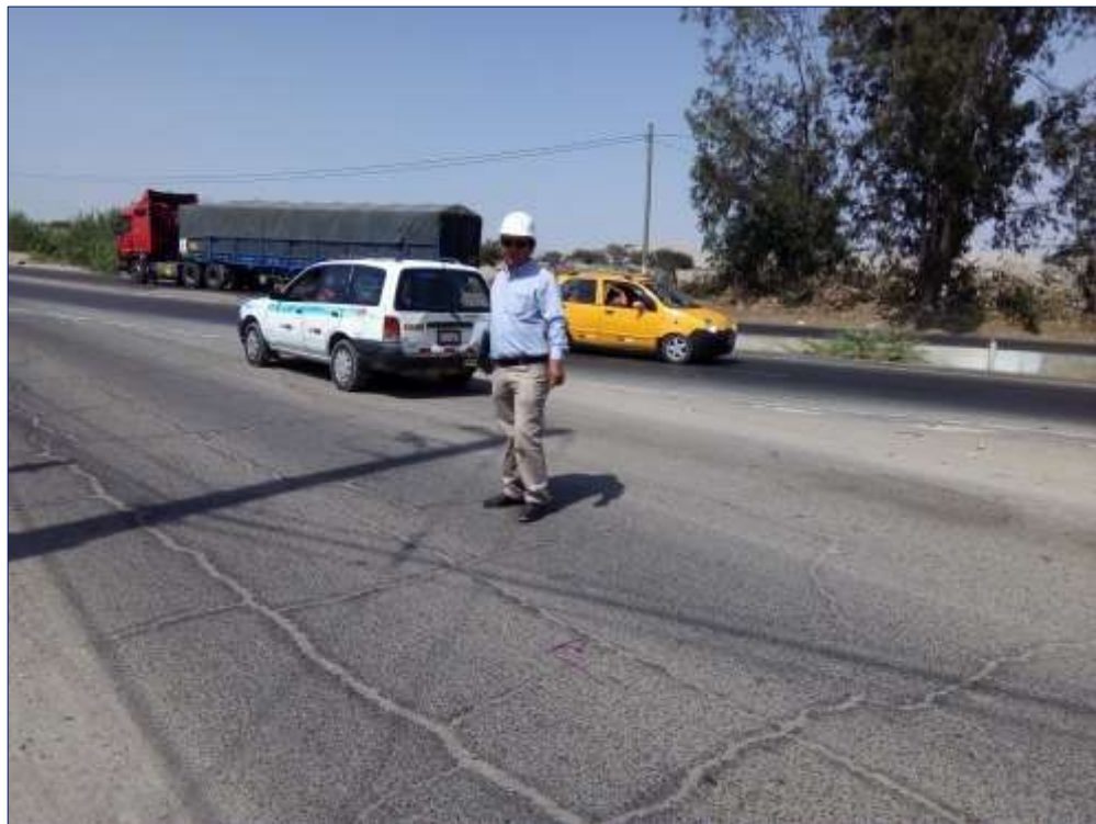
FISURAS LONGITUDINALES Y TRANSVERSALES
