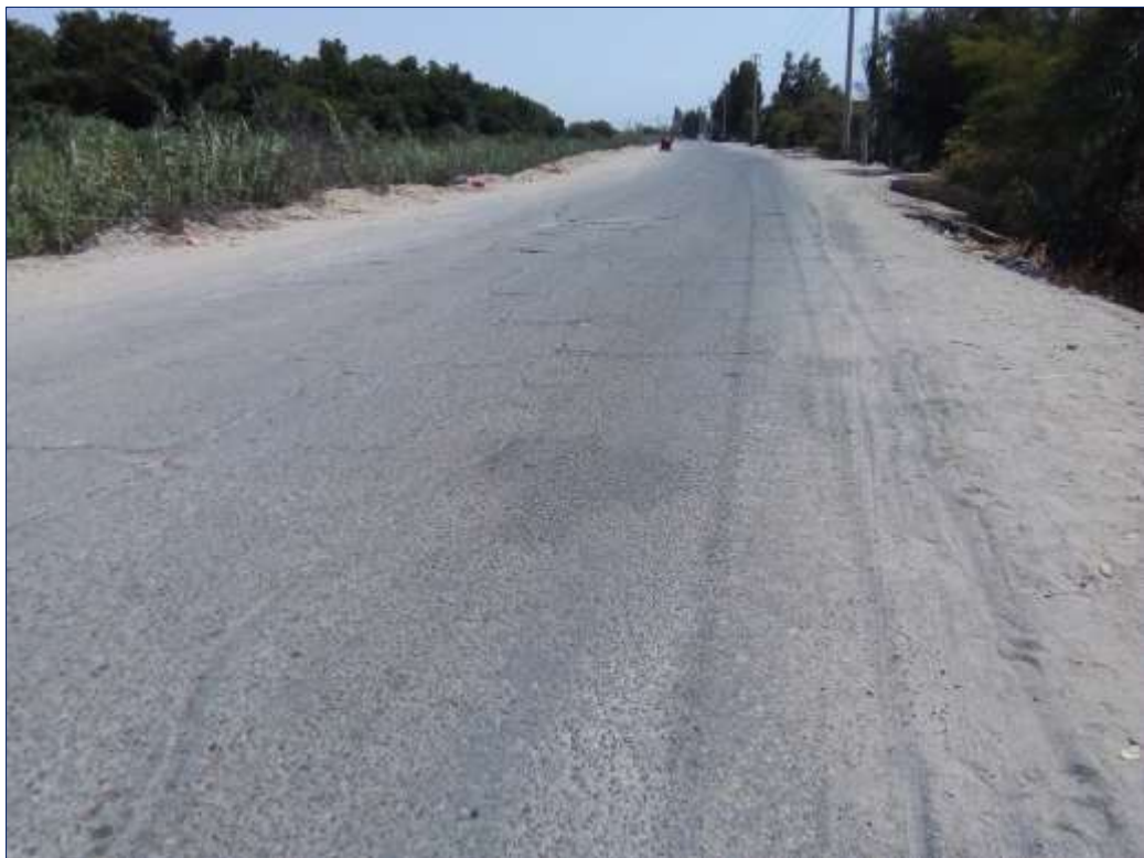
PELADURA POR INTEMPERISMO
