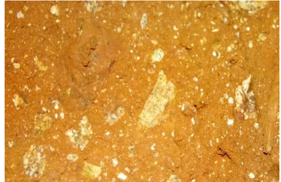
LADRILLO COSIDO CON PRESENCIA DE CARBONATOS
