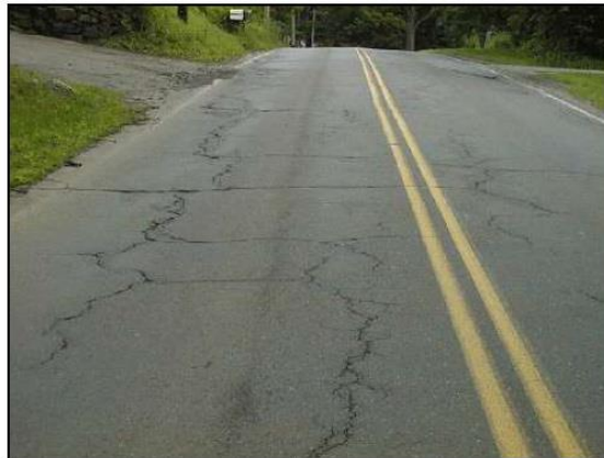
Fisuras interconectadas que forman bloques
