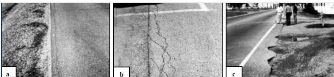
Fisura de Borde de nivel de severidad baja(a), medio (b), y alto(c).
