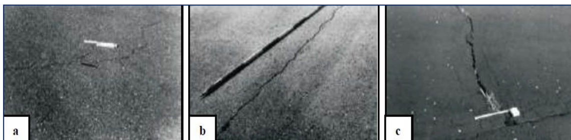
Fisura Longitudinal y Transversal de nivel de severidad baja(a), medio (b), y alto(c).
