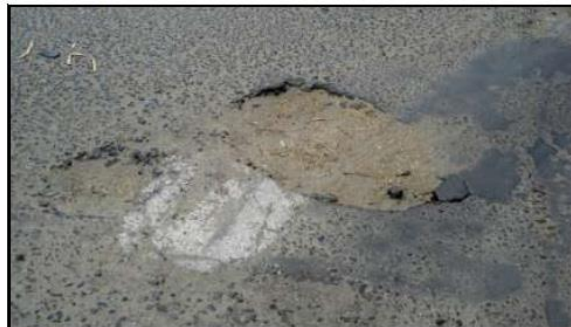
Baches encontrados en medio del pavimento
