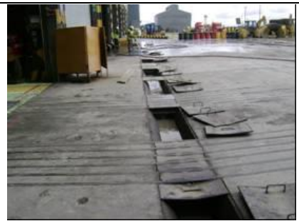
Canaletas para la evacuación de los efluentes resultado de la limpieza del área, los cuales desembocan a 2 fases: bombeo para reutilizar y a la Relavera de Huanipampa
