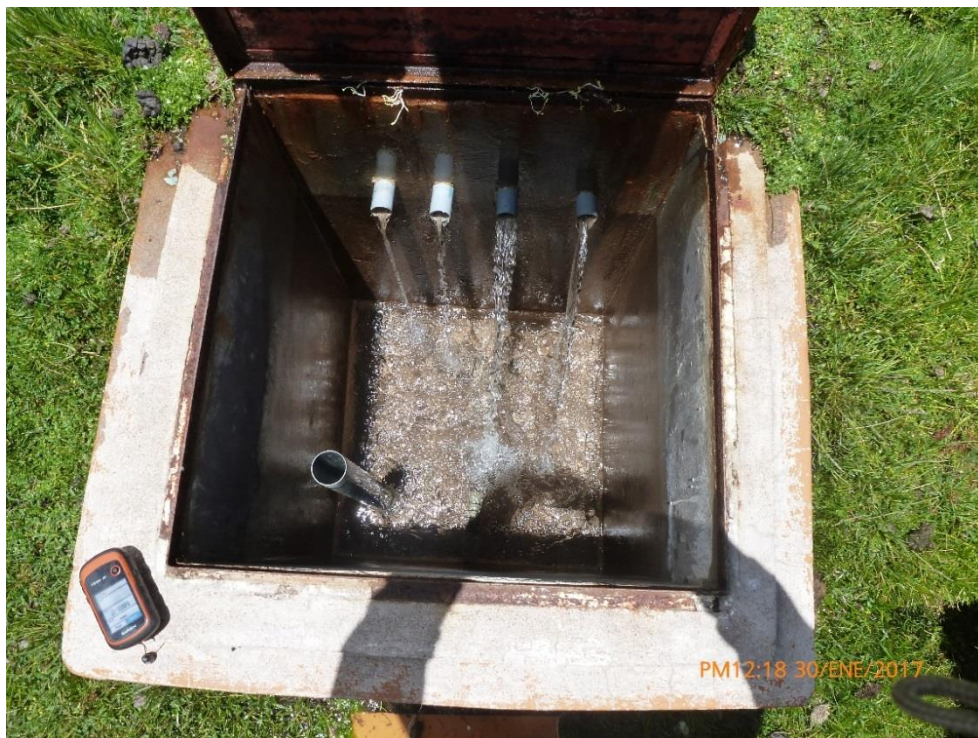
Imagen 20: Captación 2, Sector Paccobamba – Huaccuyo (mal estado)
