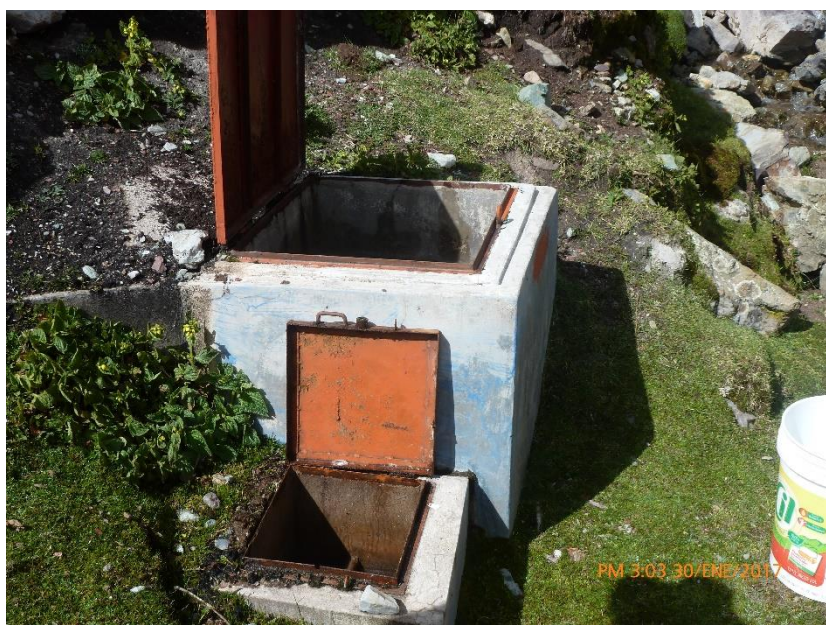
Imagen 41: Captación existente N° 3, en el sector de Paccobamba, barrio Chilluyoc.
