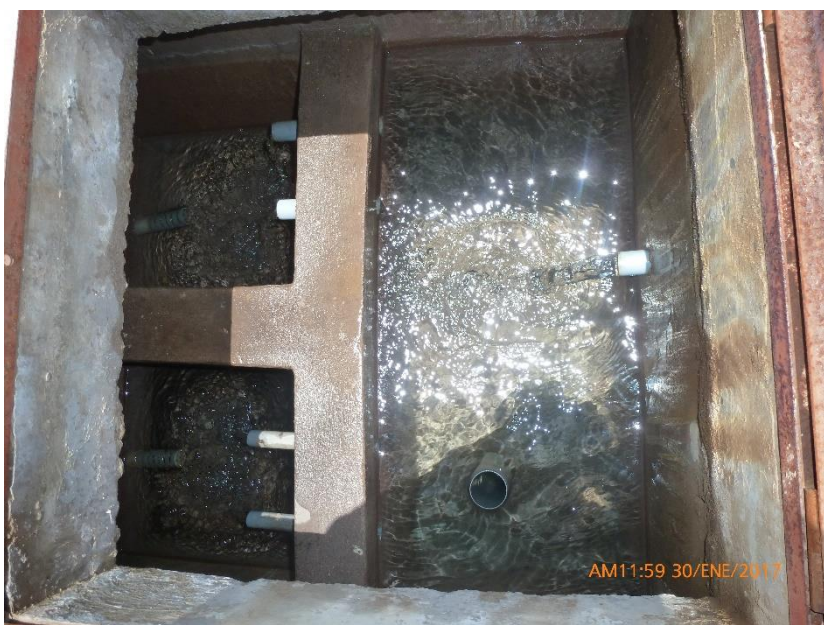
Imagen 43: Cámara de distribución de caudales existente, en el sector de Paccobamba
