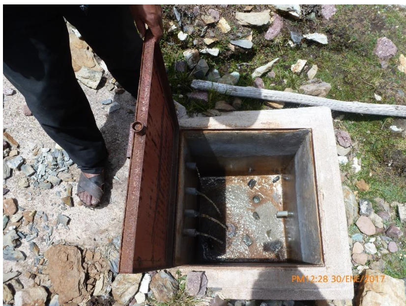
Imagen 39: Captación existente N° 1, en el sector de Paccobamba, barrio Huaccuyo
