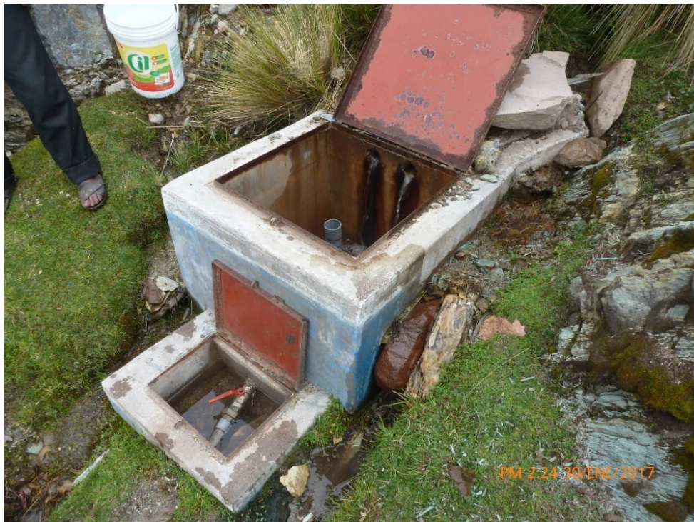
Imagen 22: Captación, Sector Chullunquiani – Huañuyoc (mal estado)
