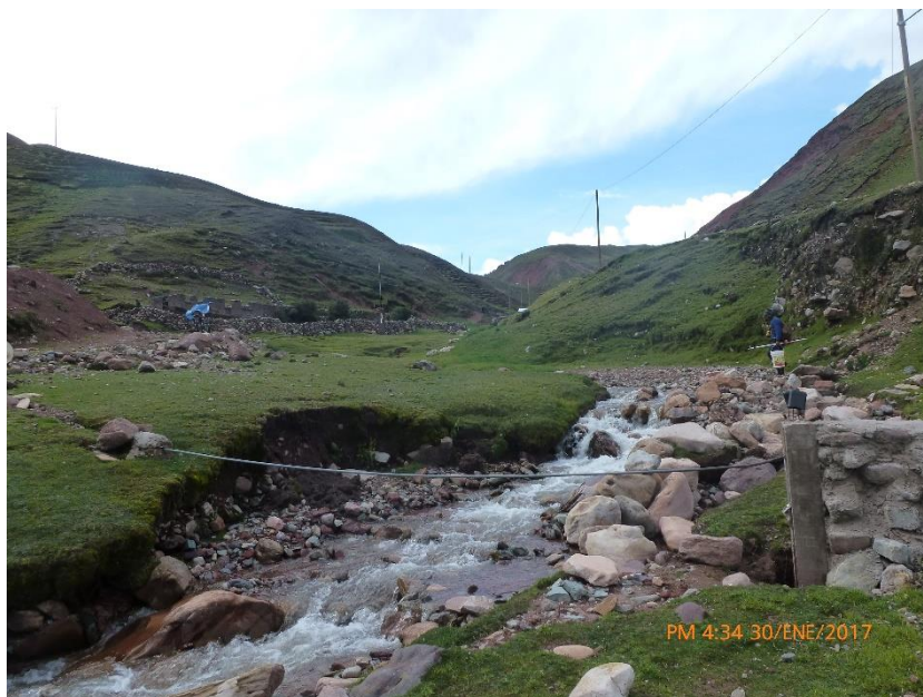
Imagen 47: Pase aéreo existente en mal estado - que conduce hacia la I.E.I
