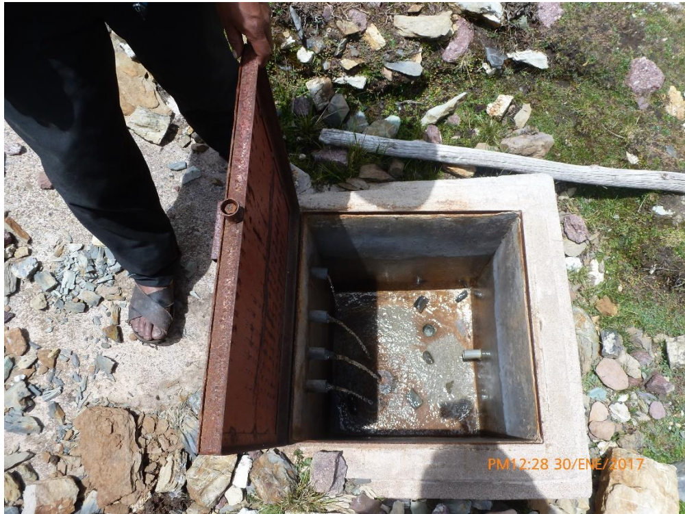
Imagen 19: Captación, Sector Paccobamba – Huaccuyo (mal estado)
