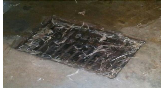
CF1. Sistema de drenaje (desagüe)
