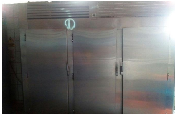
CF14. Cámara Frigorífica
