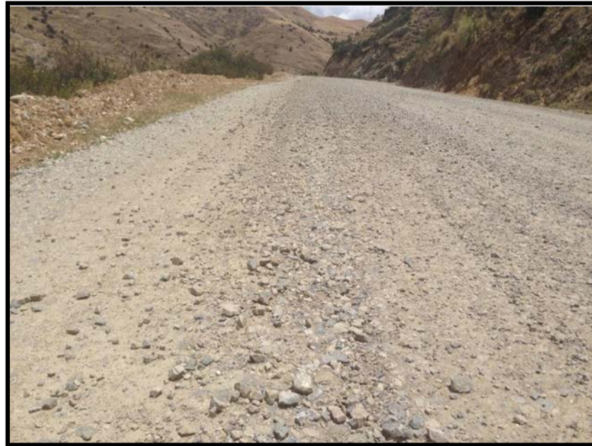
FIGURA N°. 2 PERDIDA DE MATERIAL FINO
