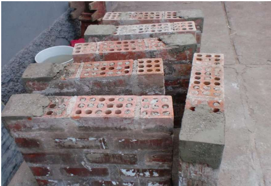
FOTO N°62: Colocado de capinng en zonas donde el prisma estará en contacto con los cabezales.
