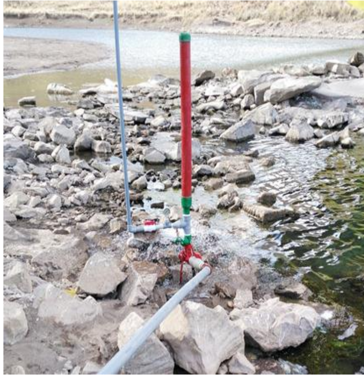
Foto 9. Funcionamiento del sistema de bombeo
