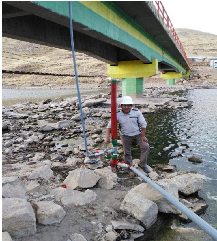
Foto 8. Cámara de aire
