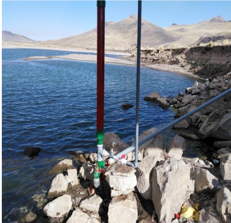
Foto 7. Tubería de suministro y línea de entrega
