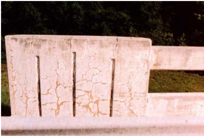
FOTO 3.5 Elemento de concreto armado afectado por la reacción álcali-sílice.
