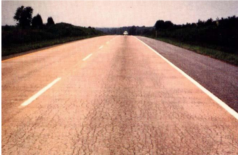
FOTO 3.8 Pavimento de concreto afectado por una fisuración debida a la reacción álcali-carbonato
