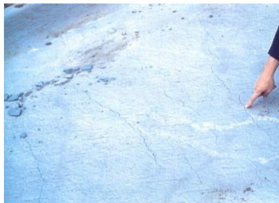
FOTO 4.2 Patrón típico de fisuración por contracción plástica.
