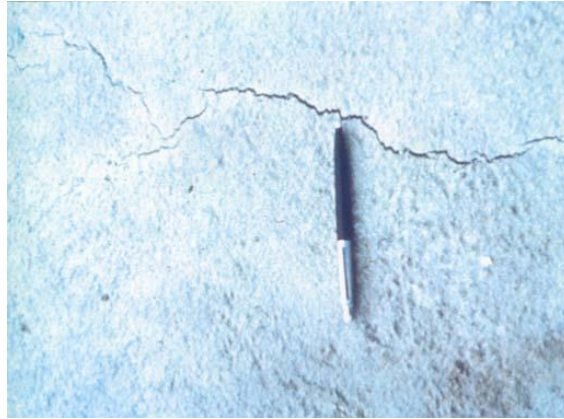
FOTO 4.1 Losa de concreto armado fisurada por la contracción plástica (comparación con un lapicero para tener una relación del tamaño de la fisura)
