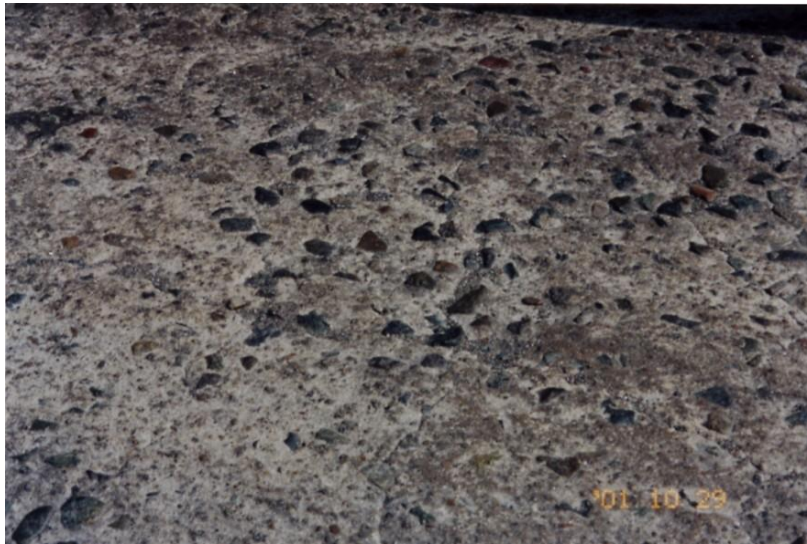
FOTO 3.10 Pavimento de concreto afectado por la abrasión.
