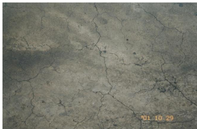
FOTO 5.2 Patrón de fisuración con contracción o retracción por secado.
