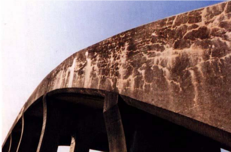
FOTO 3.7 Puente de concreto armado afectado por la reacción álcali-agregado
