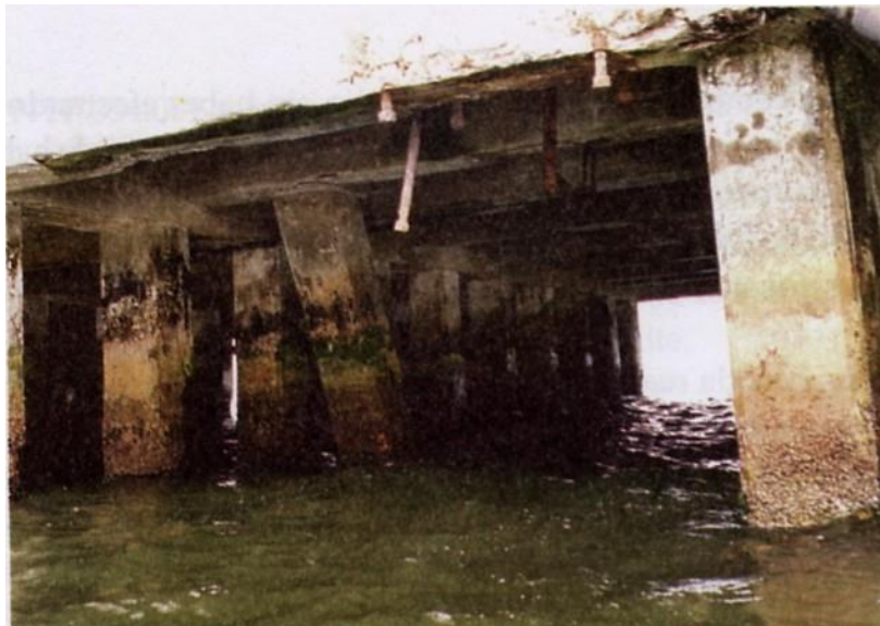
FOTO 3.9 Muestras de corrosión en el muelle de concreto en las zonas de alta y baja marea y en la zona de salpicadura.
