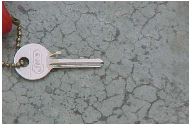
FOTO 5.1 Losa de concreto fisurada debido a la contracción por secado (comparado con una llave para determinar el tamaño de la fisura)
