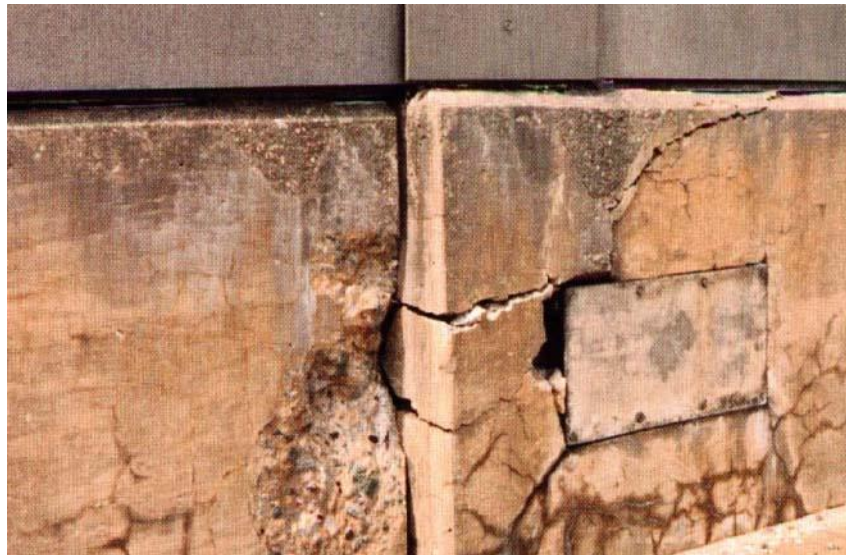
FOTO 3.6 Patrón típico de fisuración debida a la reacción álcali-sílice.
