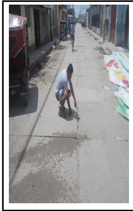
IMAGEN N°46 – Junta de dilatación con mayor espesor que el recomendado según norma Jr. Libertad cdra. 9 frente al lote 73
