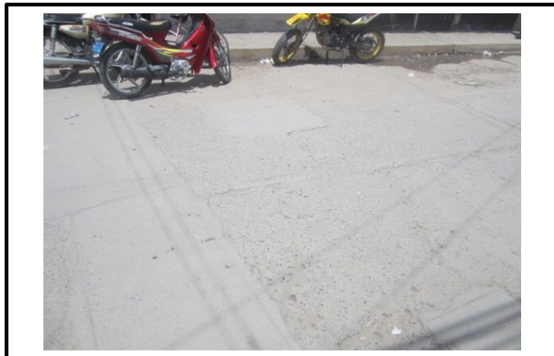
IMAGEN N°45 – Erosión de la superficie del pavimento rígido Jr. Libertad cuadra 9 lote 33.
