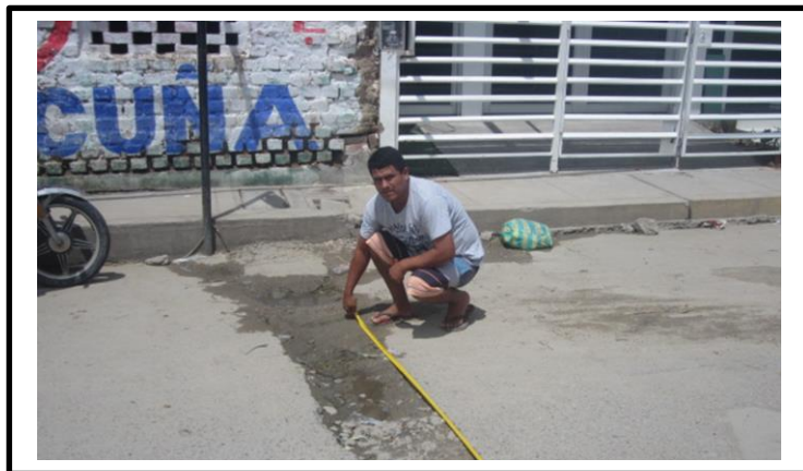
IMAGEN N°59 - Parche en mal Estado
