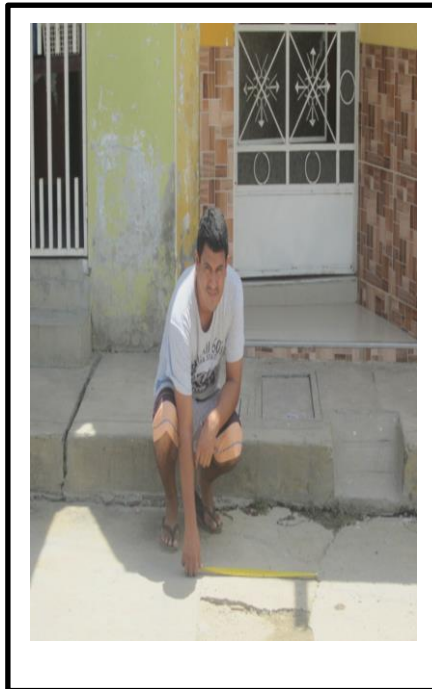
IMAGEN N°48 – Parche en mal estado Jr. Libertad cdra. 9 frete lote 73
