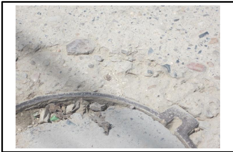
IMAGEN N°56 - Desprendimiento de concreto y fisuras
