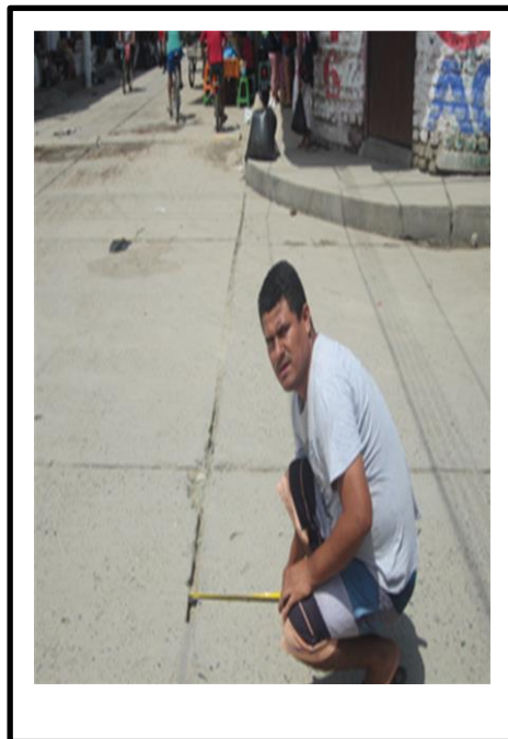
IMAGEN N°51 – Separación de juntas de dilatación Jr. Libertad cdra. 9 con intersección Jr. Pisagua
