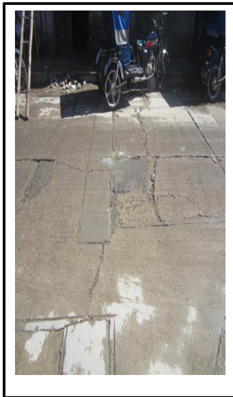
IMAGEN N° 53 – Agrietamiento múltiple Jr. libertad cdra. 9 frente al lote 33 cercado de Chulucanas
