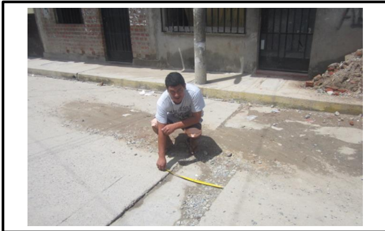
IMAGEN N°44- Parche de concreto en mal estado Jr. Libertad cdra. 9 al costado de la ferretería keisko
