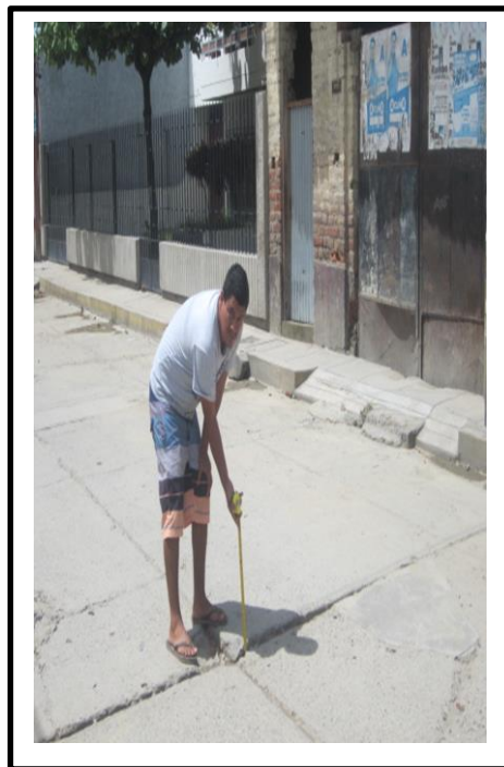
IMAGEN N°47 – Juntas elevadas Jr. Libertad cdra. 9 frente al lote 33
