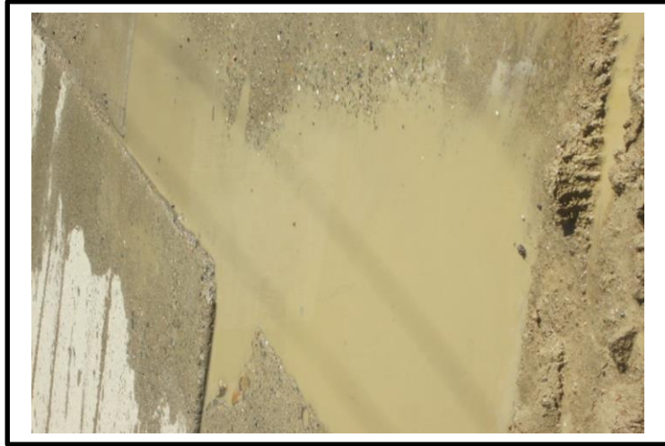
IMAGEN N°60 – Baches por hundimiento
