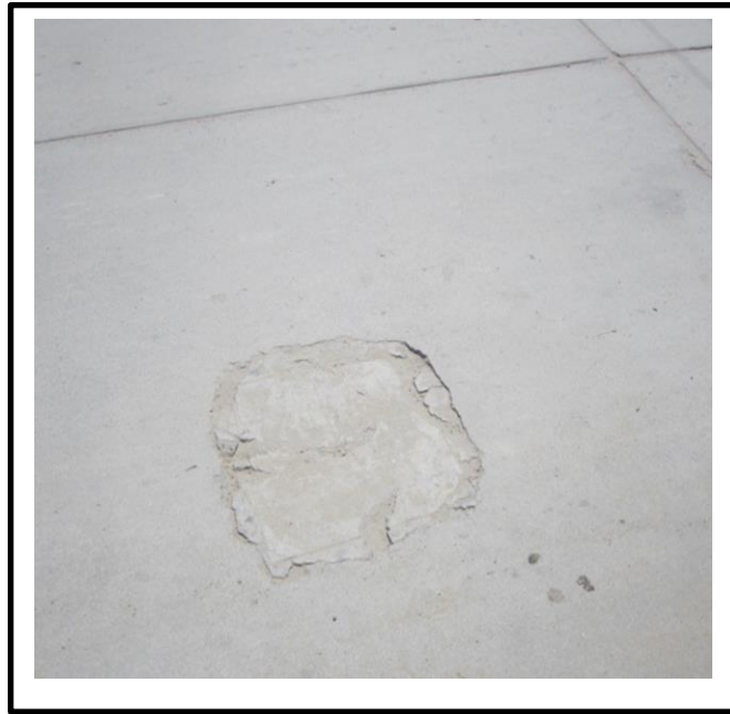
IMAGEN N°58 - descascaramiento de los parches
