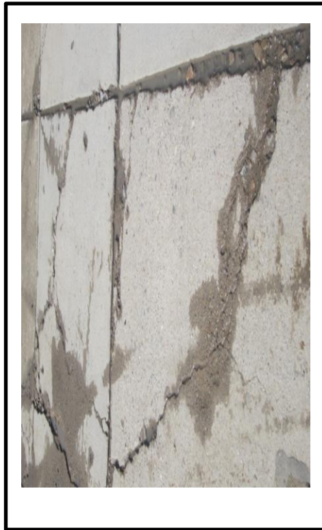
IMAGEN N°50 – Agrietamiento en esquinas Jr. Libertad cuadra 10 intersección con Jr. Pisagua
