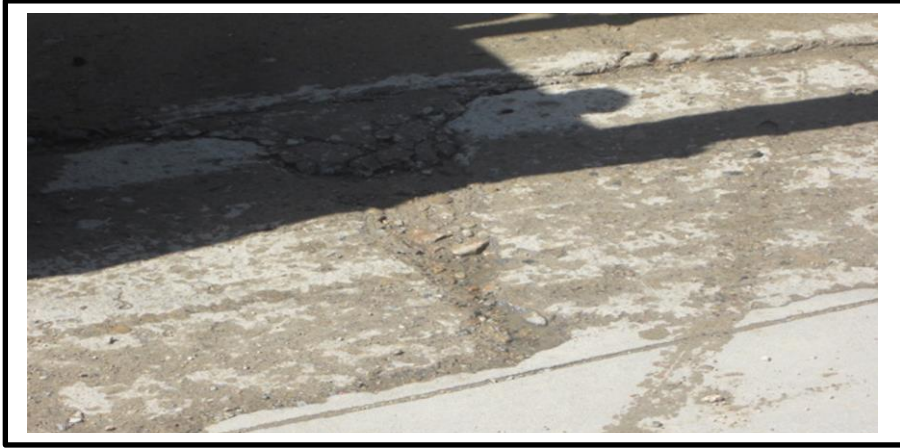
IMAGEN N° 52 – Desprendimiento de la superficie del pavimento rígido Jr. Libertad cdra. 9 lote 74
