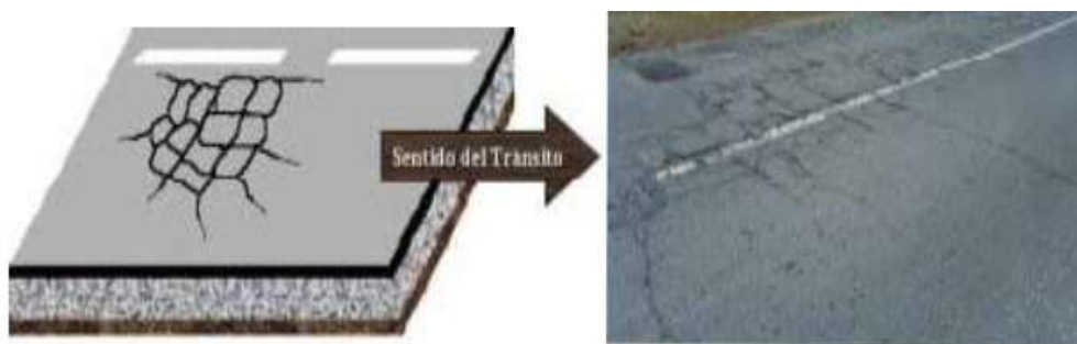
FÍGURA Nº 04: AGRIETAMIENTOS EN BLOQUE
