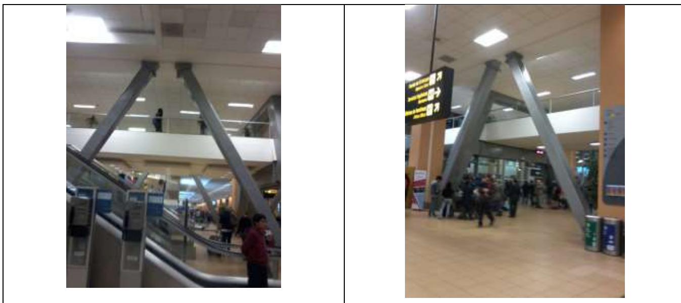
(Figura 17) Disipadores sísmicos en Aeropuerto Jorge Chavez de Lima Fuente: propio
