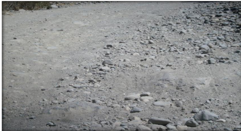
Figura 3.13. Trocha carrozable en mal estado tramo Ichupampa - Lari.
